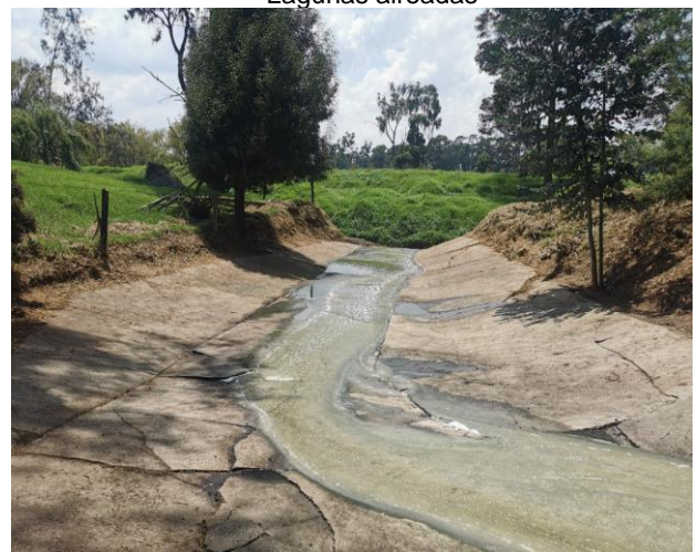
Canal abierto a vertimiento
