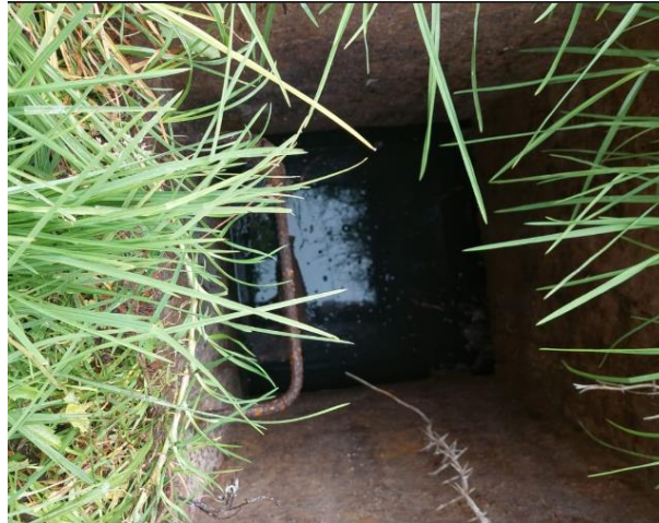
Imagen 1. Pozo séptico vereda La Violeta
