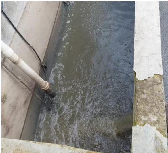
Bombeo a reactores 1 y 2
