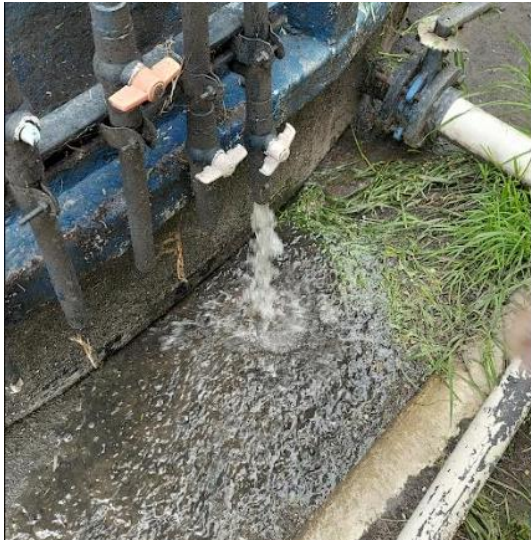
Válvula de purga reactor UASB
