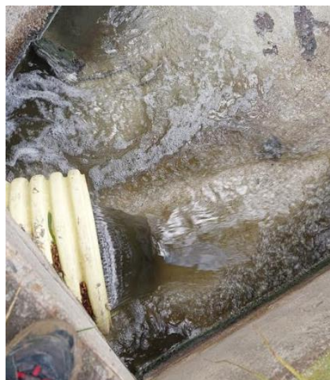
Cabezal de descarga
