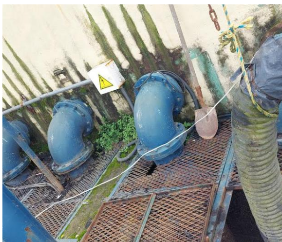
Sistema de bombeo
