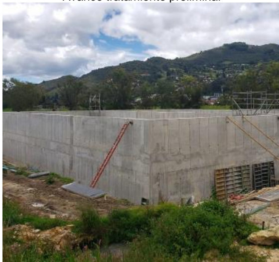
Tanque de aireación
