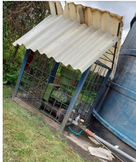
Sistema de bombeo reactor 1
