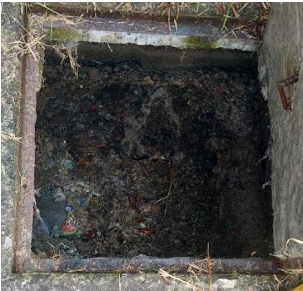
Estructura de trampa de grasa
