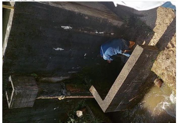
Purga de Lodos
