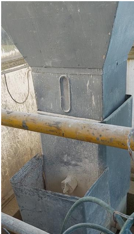
Dosificador de Cal
