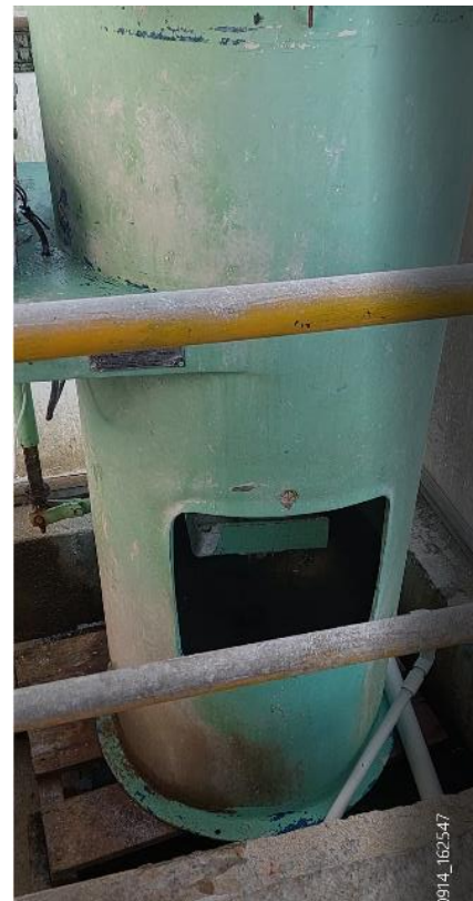
Dosificador de Sulfato de Aluminio
