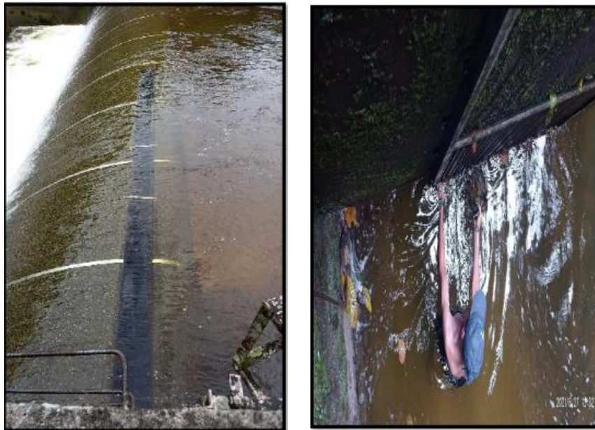
Imagen 5. Soportes mantenimientos captación
