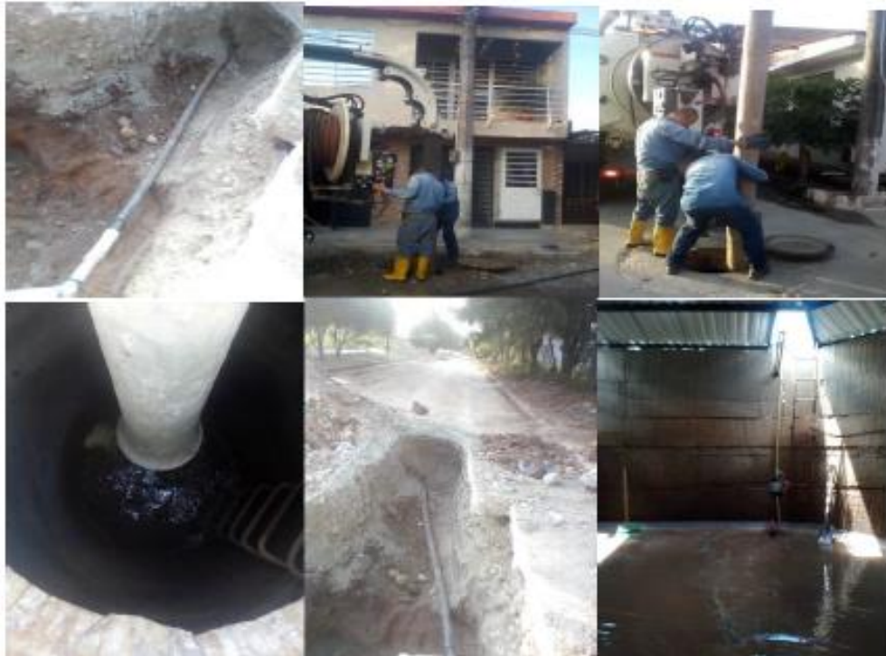
Imagen 14. Soportes mantenimientos red de alcantarillado
