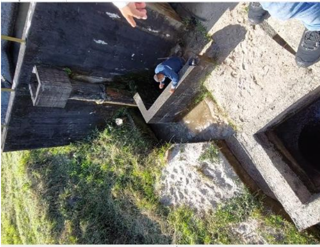
Purga de Lodos
