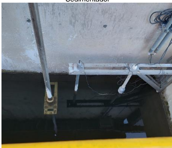
Tanque de Contacto de Cloro
