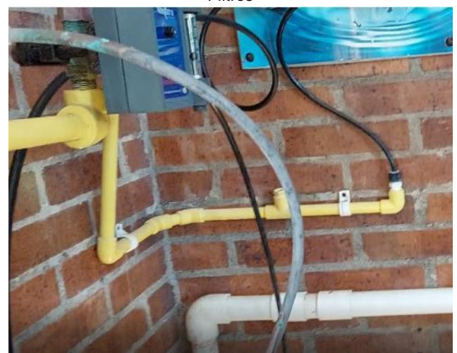
Sistema de dosificación de Cloro Gasesoso
