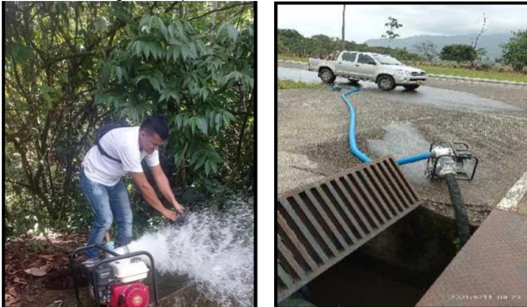
Imagen 13. Soportes mantenimientos línea de conducción
