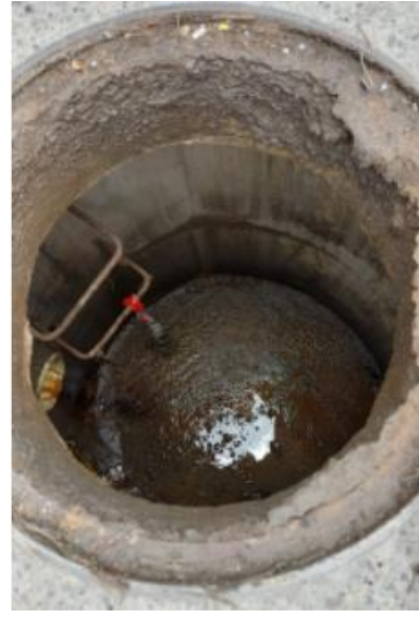
Cámara de inspección alcantarillado sanitario pluvial
