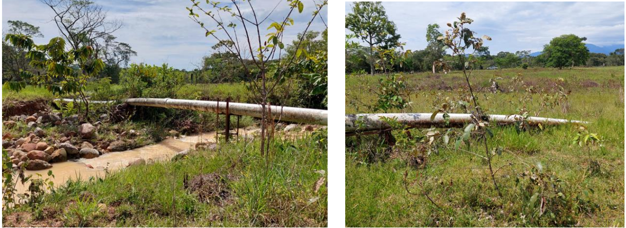
Imagen 6. Línea de aducción
