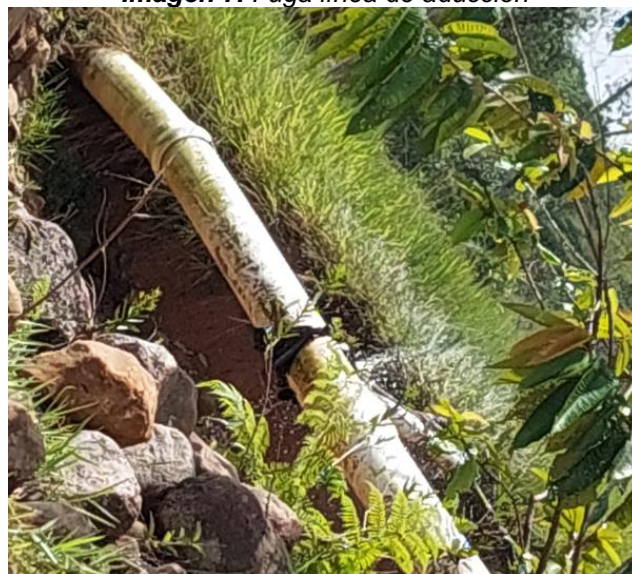
Imagen 7. Fuga línea de aducción
