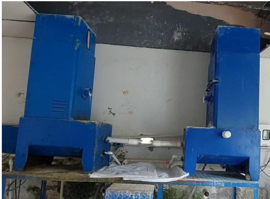
De derecha a izquierda, dosificadores de Sulfato de Aluminio y Cal
