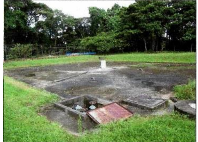
Tanque de almacenamiento 668,95 m 3
