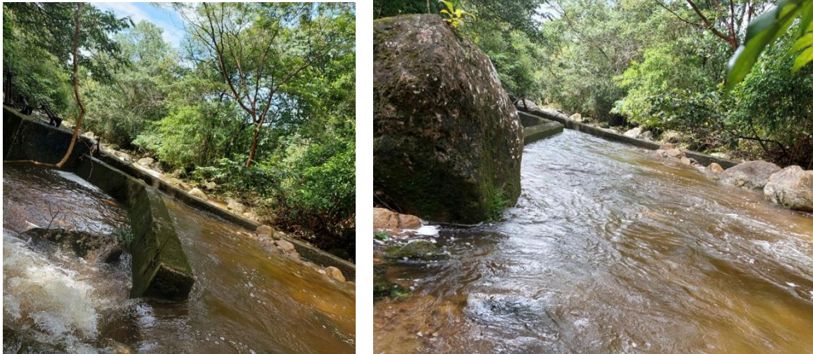
Imagen 4. Estructura de captación Río Humadea
