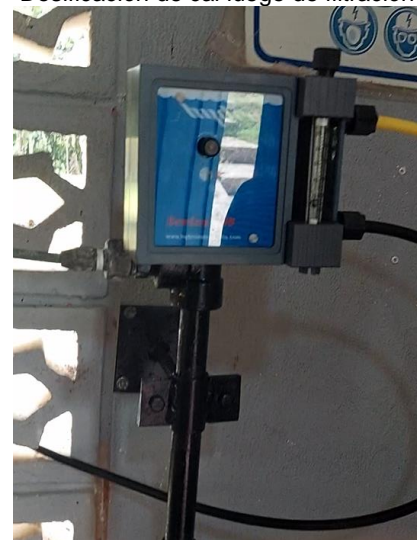
Dosificador cloro gaseoso
