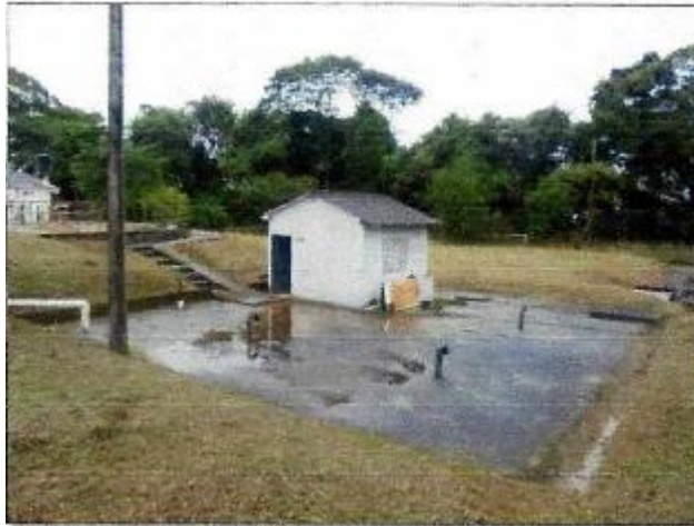
Tanque de almacenamiento 198,4 m 3
