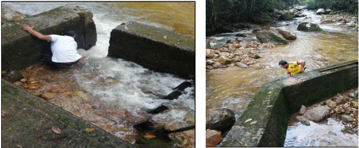
Imagen 5. Soportes mantenimientos captación
