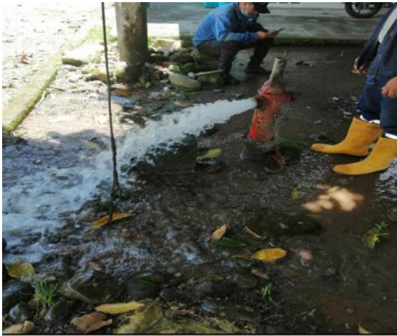
Purga red de distribución
