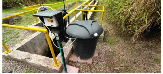
Dosificador de cal dolomita
