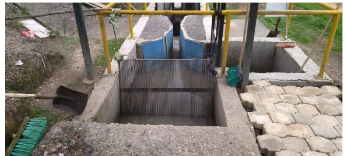
Estructura de cribado sólidos finos
