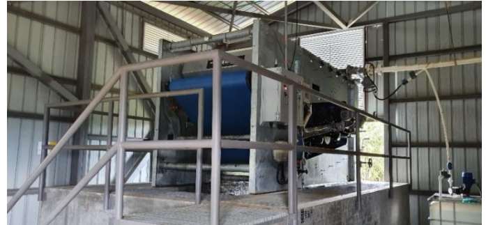
Deshidratadora de lodos
