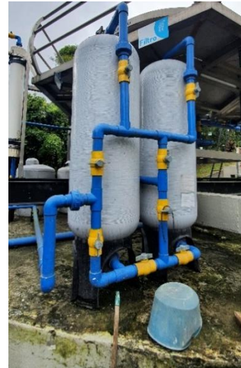
Filtros de carbón activado
