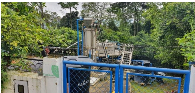
PTAR Villas del Nuevo Siglo
