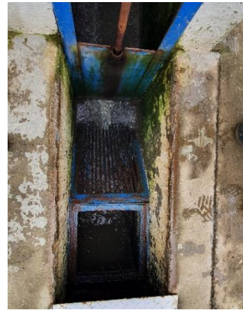
Rejillas de cribado
