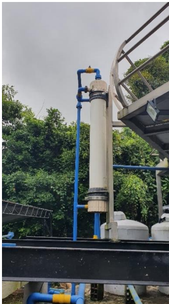
Ultrafiltración de membrana
