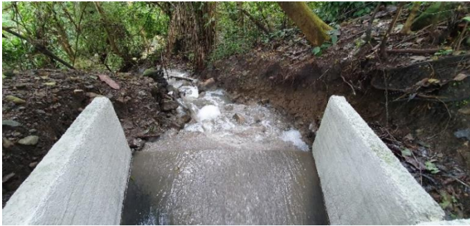
Punto de vertimiento
