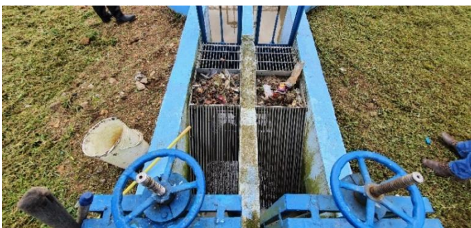
Rejillas de cribado
