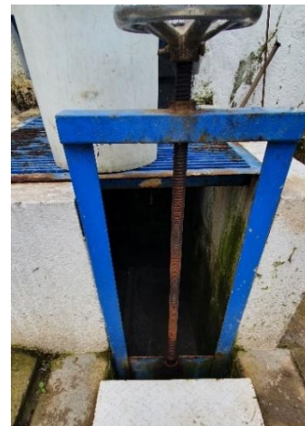
Cámara de entrada
