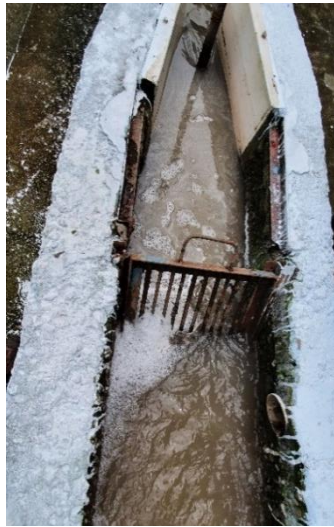
Rejillas de cribado
