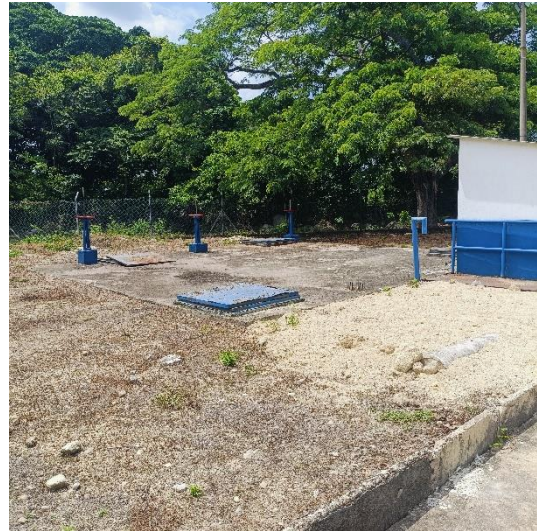
Tanque contacto de cloro
