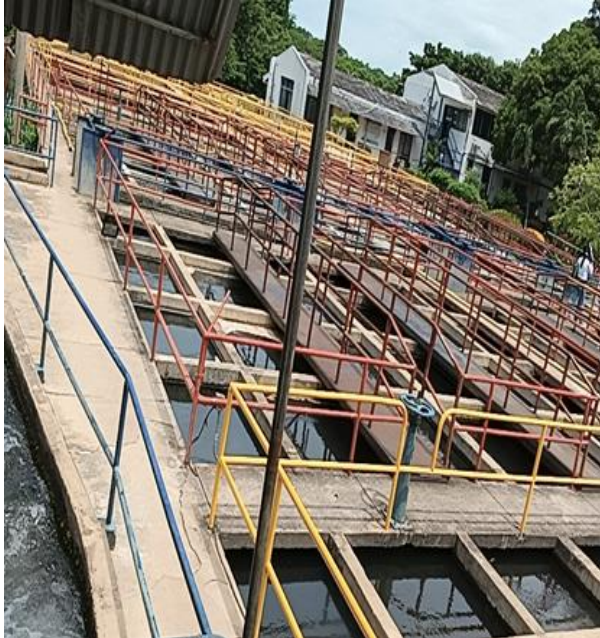
Floculadores de la PTAP Huaricha
