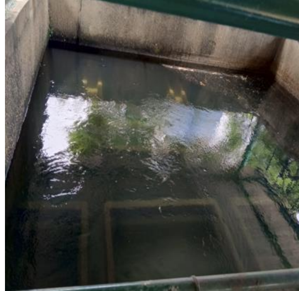
Filtros de la PTAP Gota Fría
