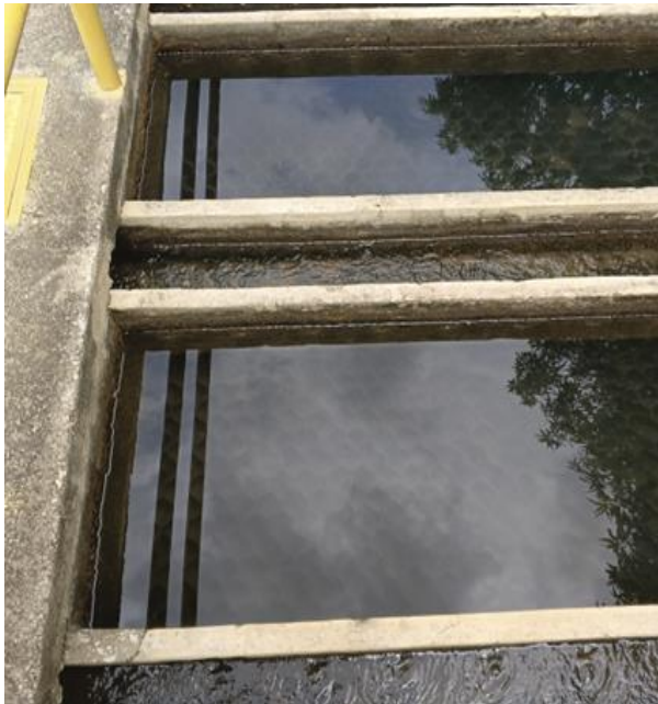
Sedimentadores de la PTAP Huaricha
