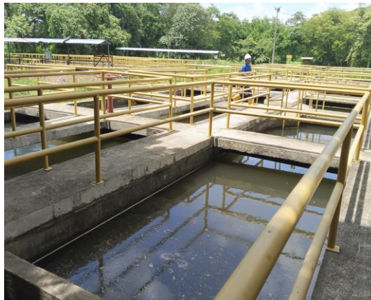
Estructura de Predesarenación
