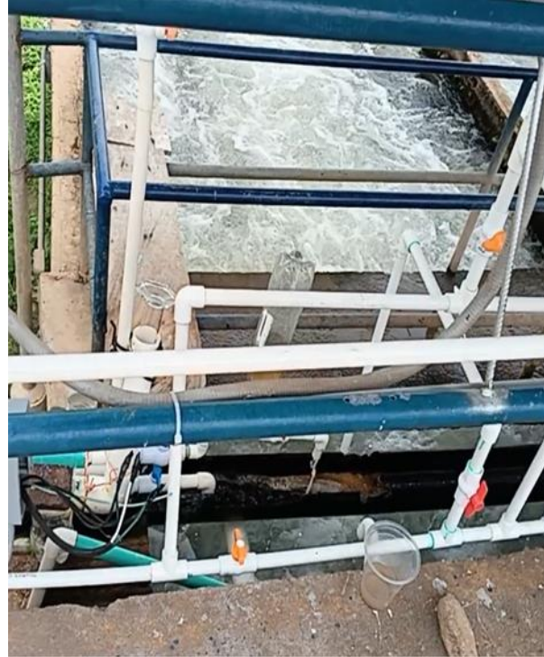
Sistema de aplicación del PAC, PTAP Gota Fría
