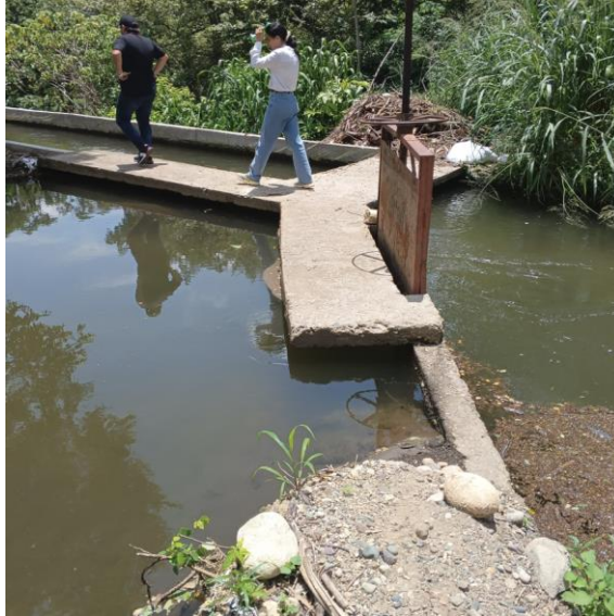
Compuertas de operación.
