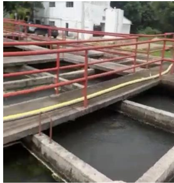
Floculadores de la PTAP Gota Fría
