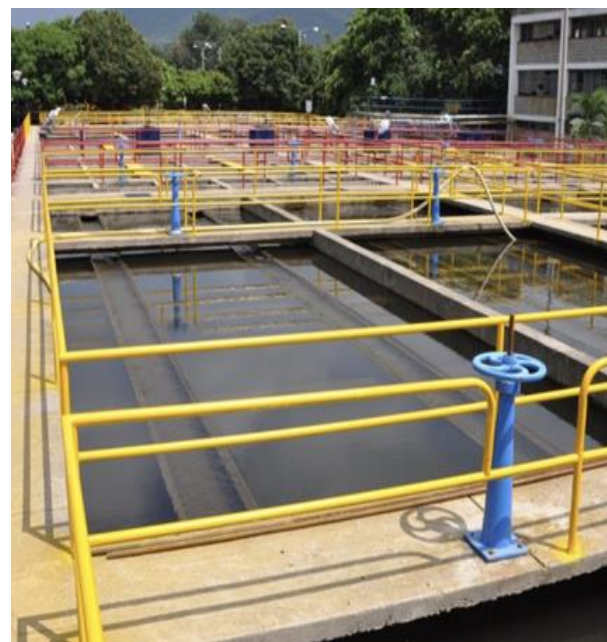
Sedimentadores de la PTAP Gota Fría
