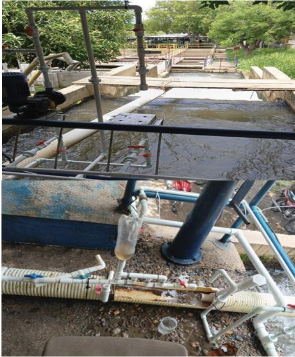
Sistema de aplicación del PAC, PTAP Huaricha
