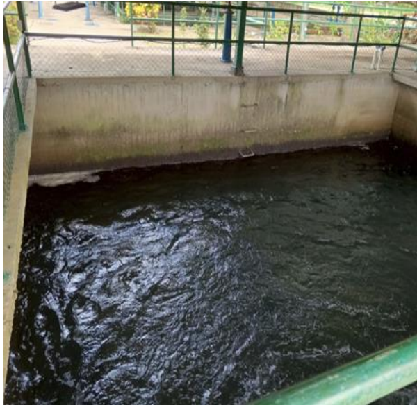
Filtros de la PTAP Huaricha
