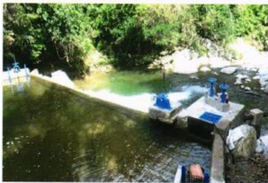
Imagen 1 Quebrada Santa Gertrudis – Captación
