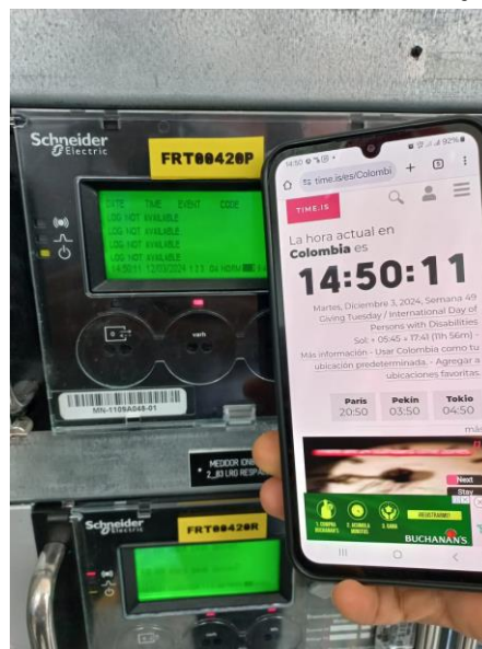
Figura 6. Verificación de la sincronización del reloj del medidor principal.
