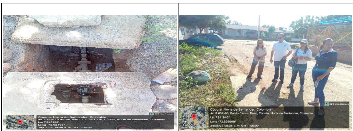
Imagen 7. Inspección pila pública funcionarios de la SSPD y Aguas Kpital S.A E.S. P
