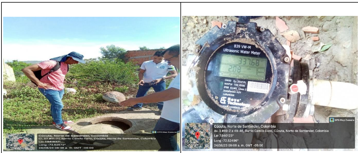
Imagen 6. Pila pública - Macromedidor del sector barrio Crispín Durán
