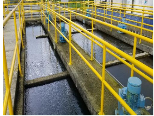
Floculadores mecánicos de eje vertical
