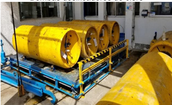
Tanques de cloro gaseoso
