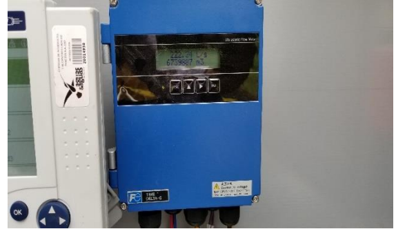
Medición de caudal a la salida de la planta
