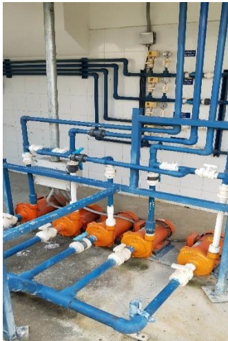
Bombas dosificadoras de cloro
