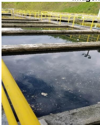
Floculadores mecánicos de eje horizontal
