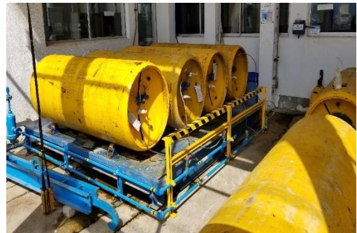
Tanques de cloro gaseoso
