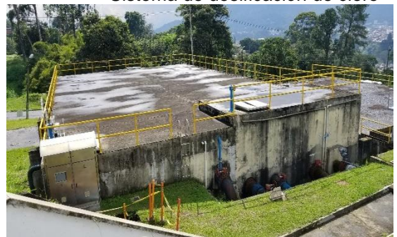
Tanque de contacto de cloro
