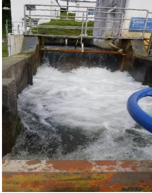
Vertedero y regleta de medición de niveles
