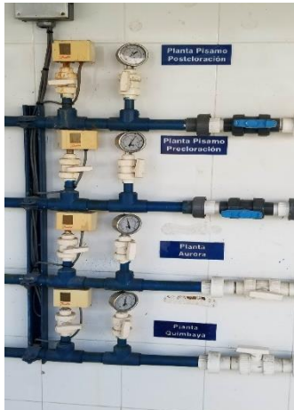
Sistema de dosificación de cloro
