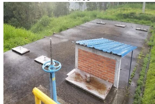
Tanque de contacto de cloro
