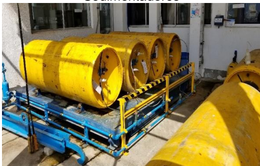
Tanques de cloro gaseoso
