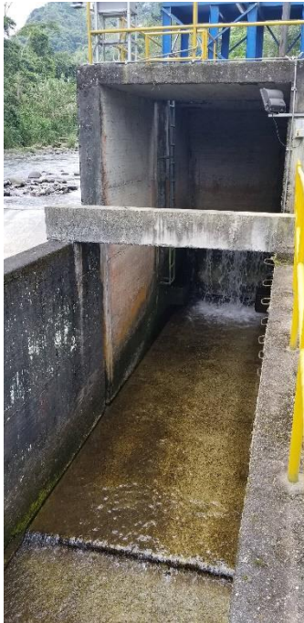
Compuerta del canal de desvío
