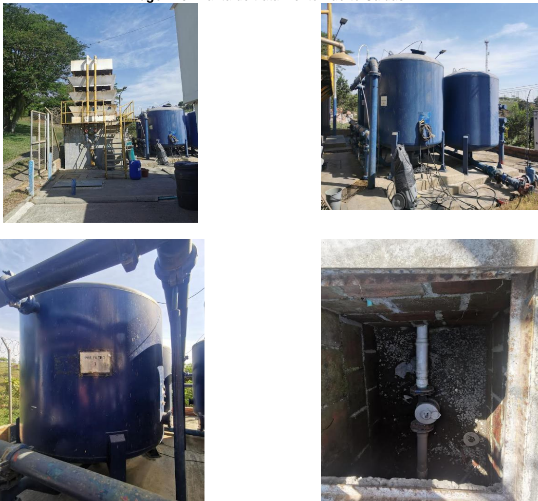
Imagen 15. Planta de tratamiento Puerto Caldas.
