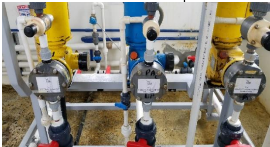
Sistema de dosificación de coagulantes
