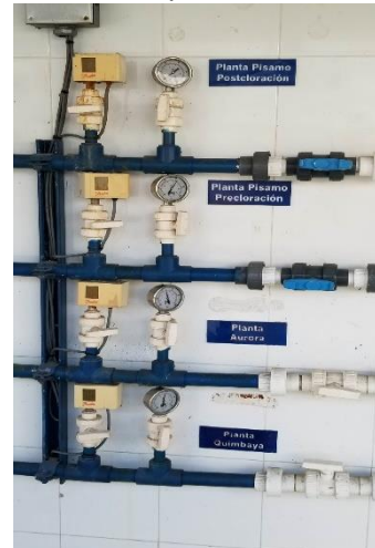
Sistema de dosificación de cloro
