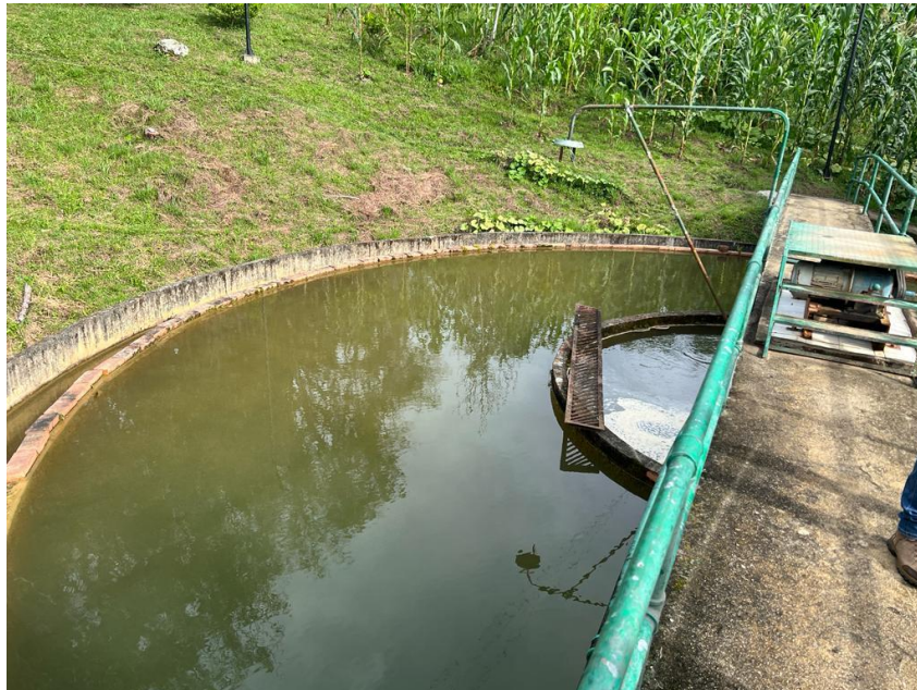
Imagen 16. Unidad de Sedimentación.
