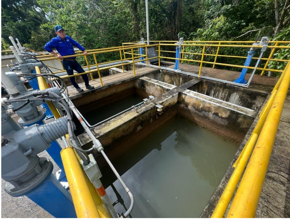
Imagen 27. Unidades de Filtración.
