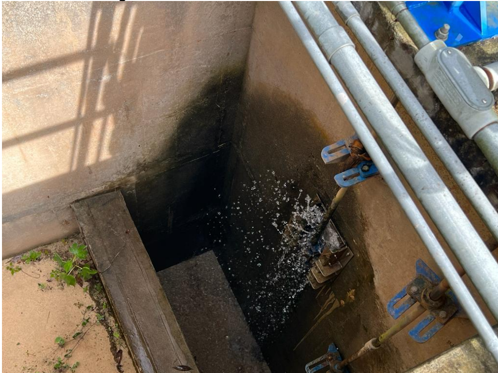
Imagen 29. Filtraciones en las unidades de filtración.
