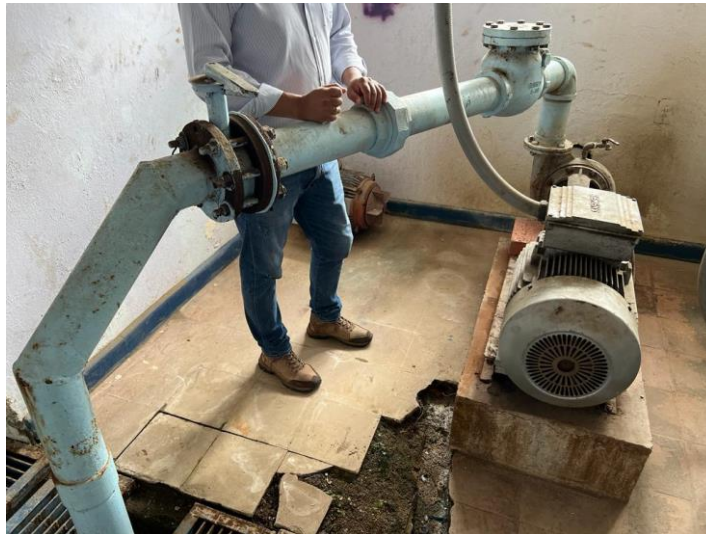
Imagen 34 Estación de bombeo PTAP
