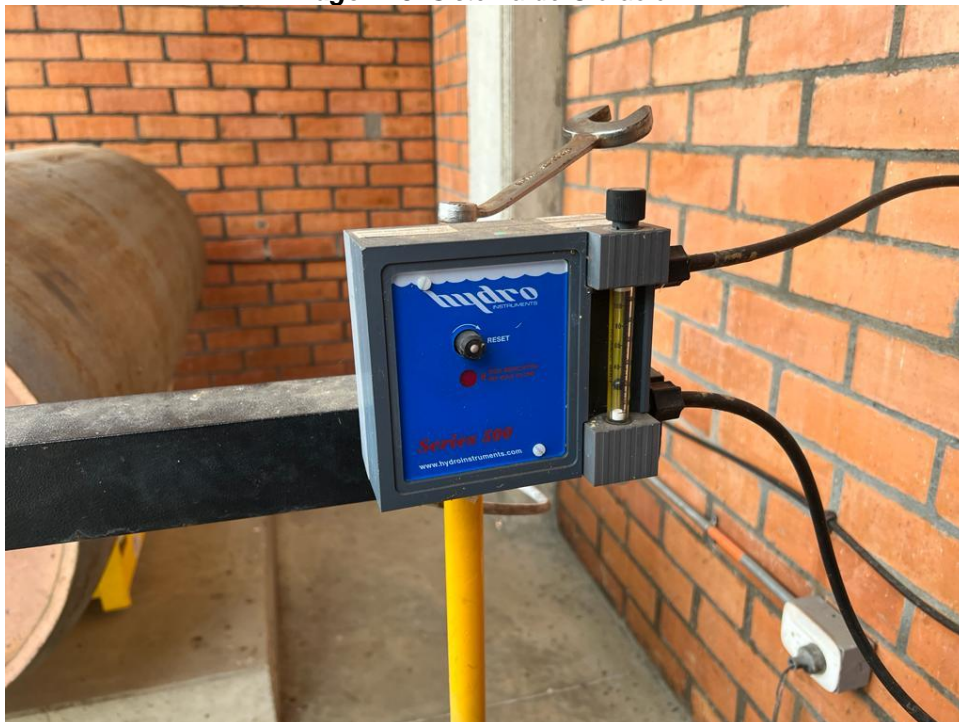
Imagen 28. Sistema de Cloración.
