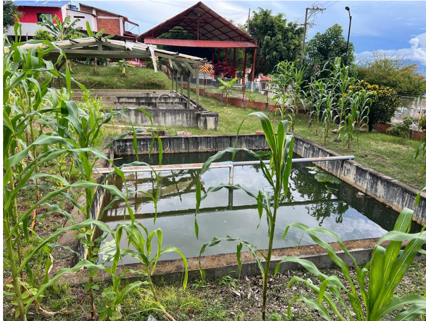
Imagen 42. Tratamiento de lodos.
