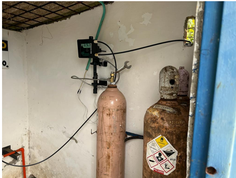
Imagen 23. Sistema de Cloración.
