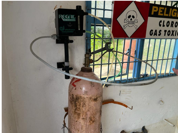
Imagen 18. Sistema de Cloración.
