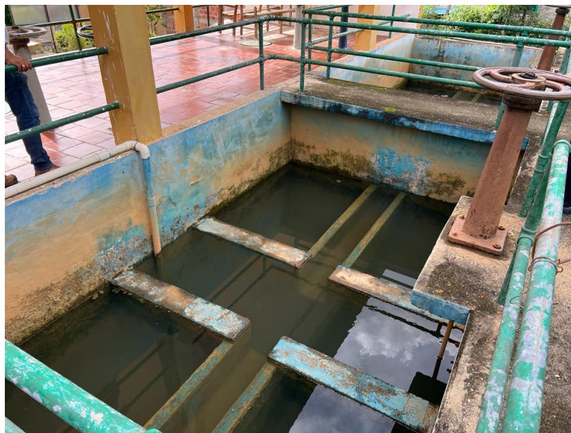
Imagen 17. Unidades de filtración.
