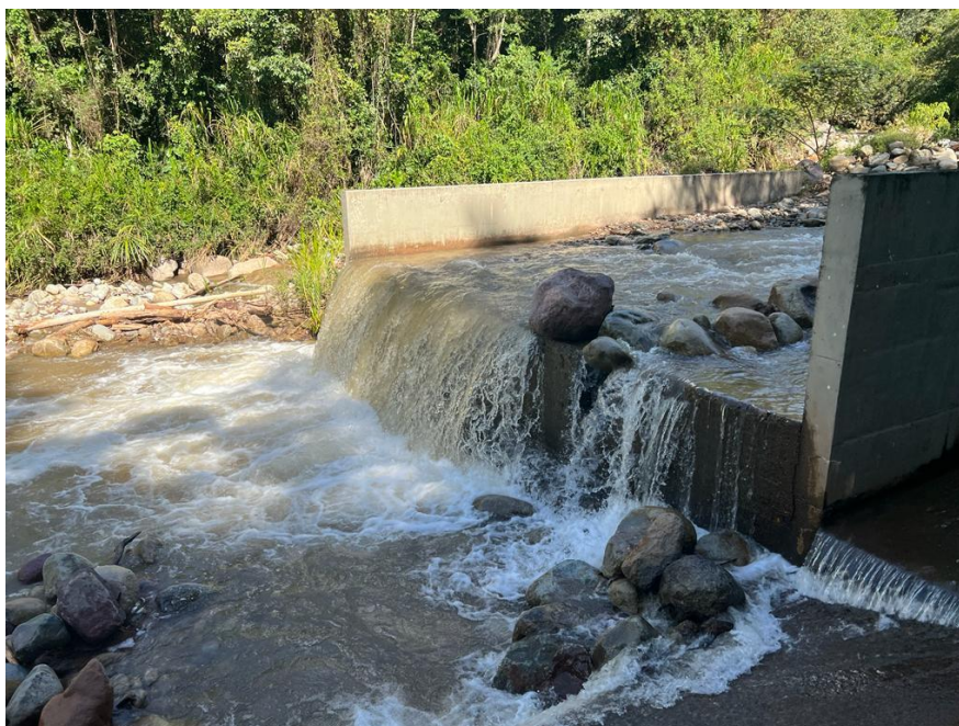
Imagen 5. Quebrada Cinco Mil – Captación.
