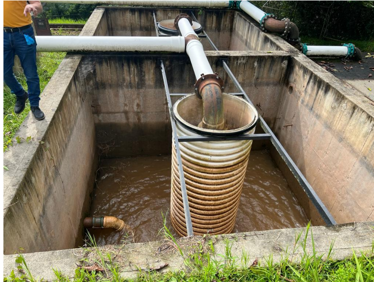
Imagen 43. Tratamiento de lodos.
