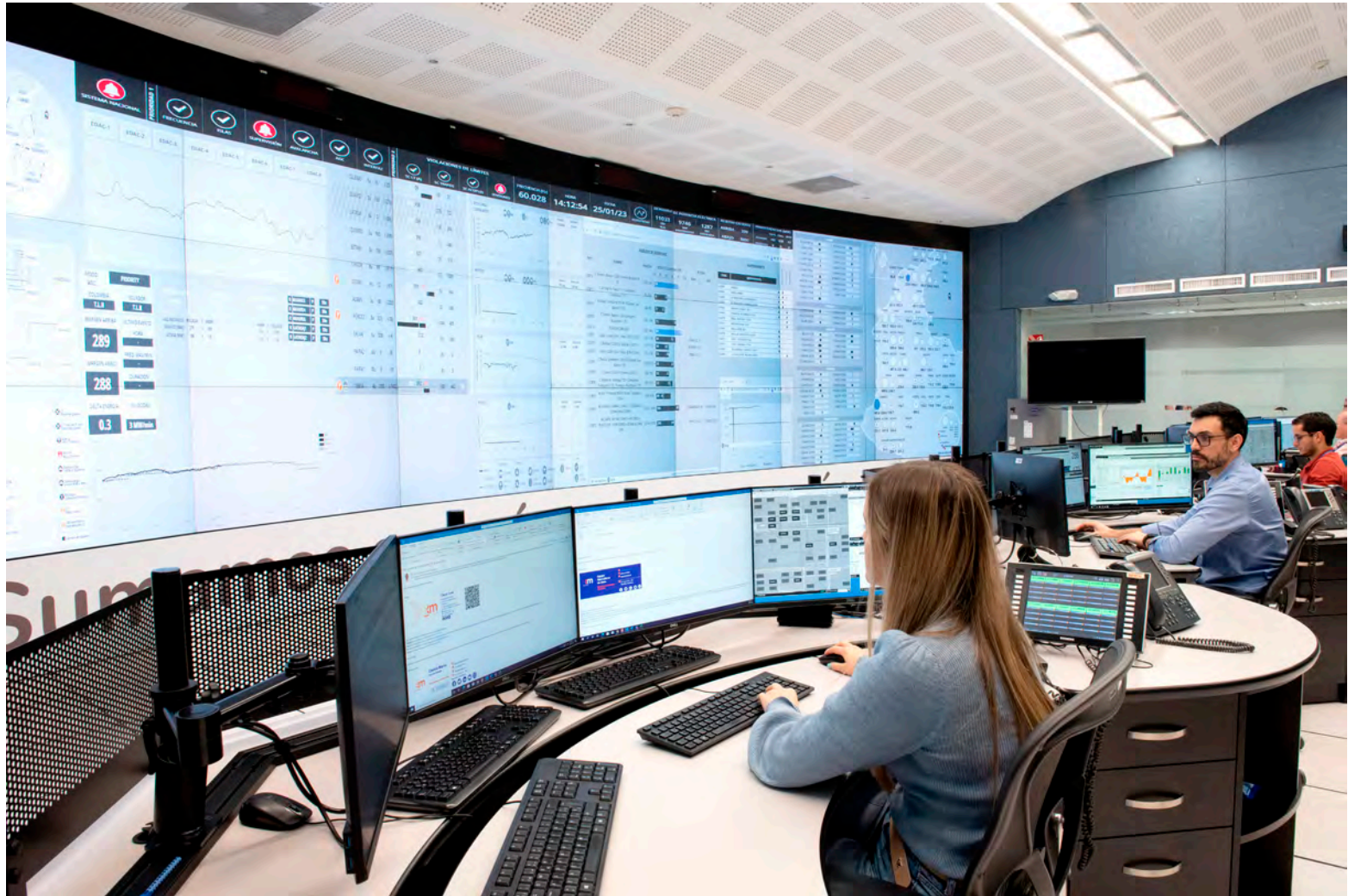
Centro de control del sistema eléctrico colombiano, donde entre otros, se planea, supervisa y controla la operación integrada de generación, interconexión y transmisión del Sistema Interconectado Nacional. Dispone de información de la red para poder actuar de manera preventiva y oportuna por la seguridad del sistema.
