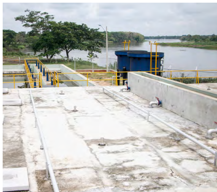
Planta de Tratamiento de Aguas Residuales de Mompós, Bolívar, con financiación de los Planes Departamentales de Agua y Saneamiento Básico (PDA), que cuenta con recursos municipales, departamentales y del Gobierno nacional. Proyecto que se desarrolla en todo el país para aumentar la cobertura del servicio de acueducto y suministrar agua potable con eficiencia en la distribución y continuidad del servicio, para mejorar las condiciones de vida de los habitantes.
