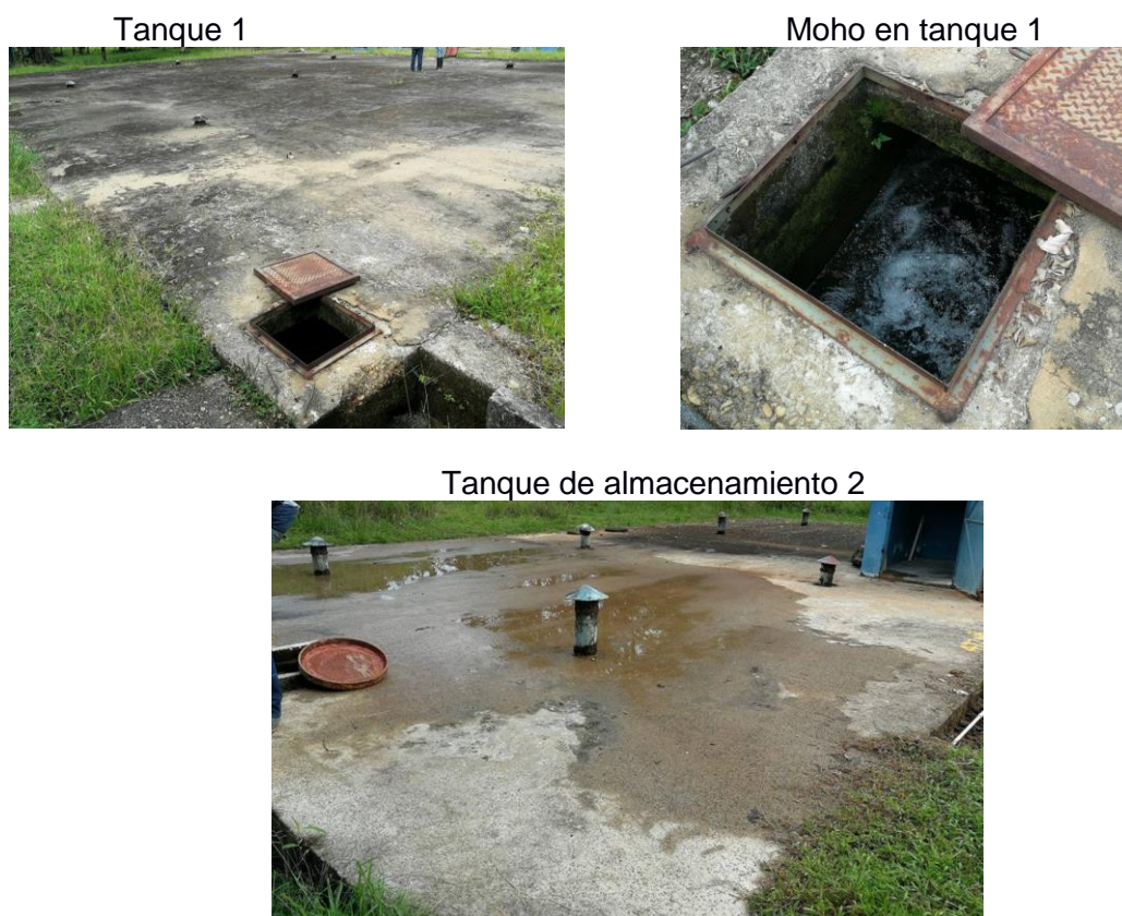
Figura 11. Tanque de almacenamiento.
