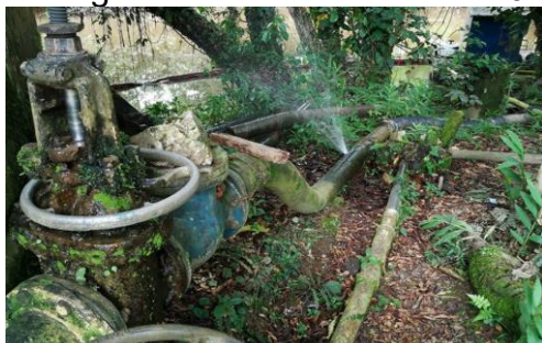
Fuga tubería de aducción de 6"
