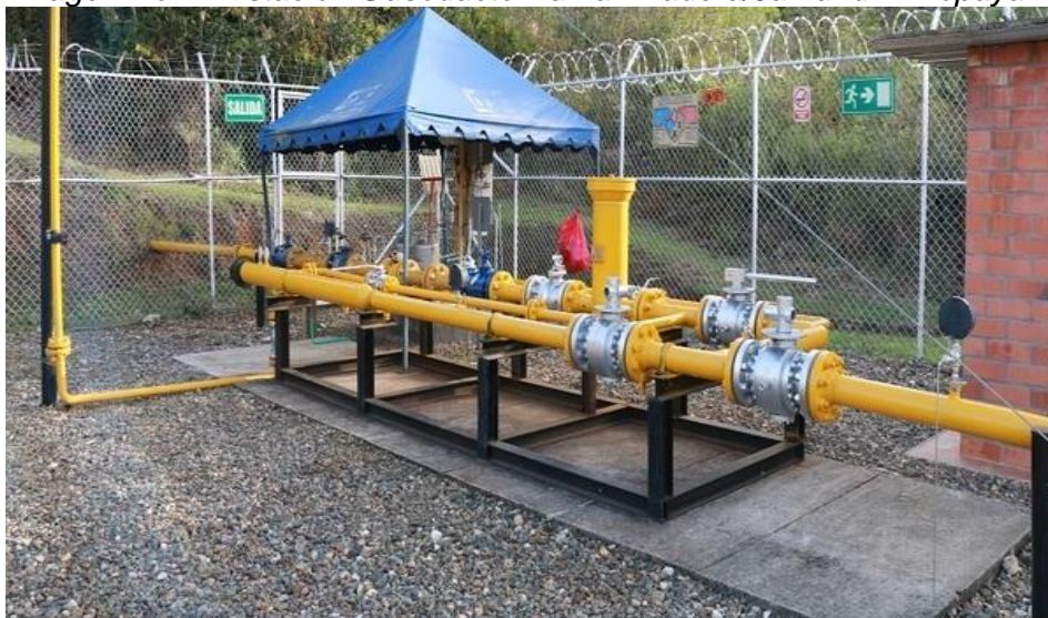
Imagen No. 7. Estación Gasoducto Ramal Pradera/Jamundí – Popayán
