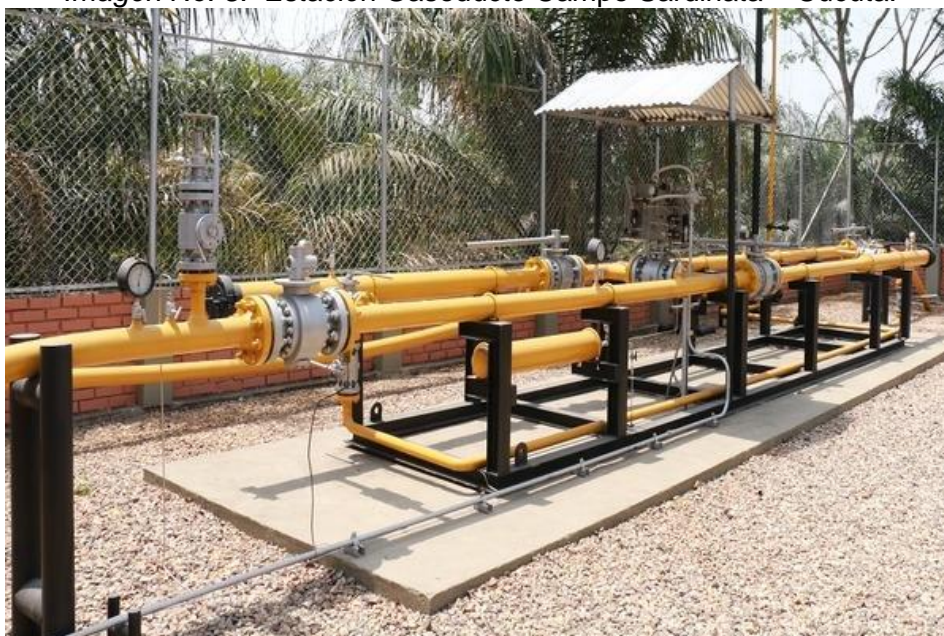
Imagen No. 8. Estación Gasoducto Campo Sardinata – Cúcuta.
