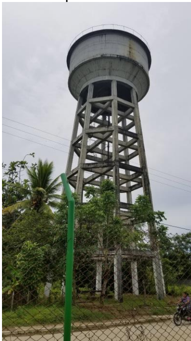
Imagen 7. Tanque de almacenamiento.
