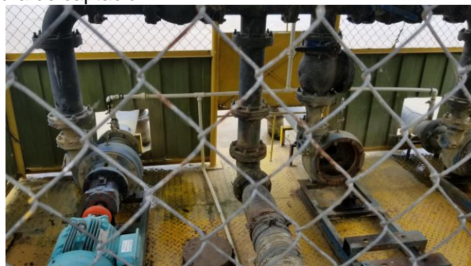
Equipos de bombeo
