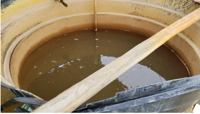
Tanque de almacenamiento de coagulante
