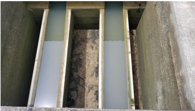
Unidades de filtración
