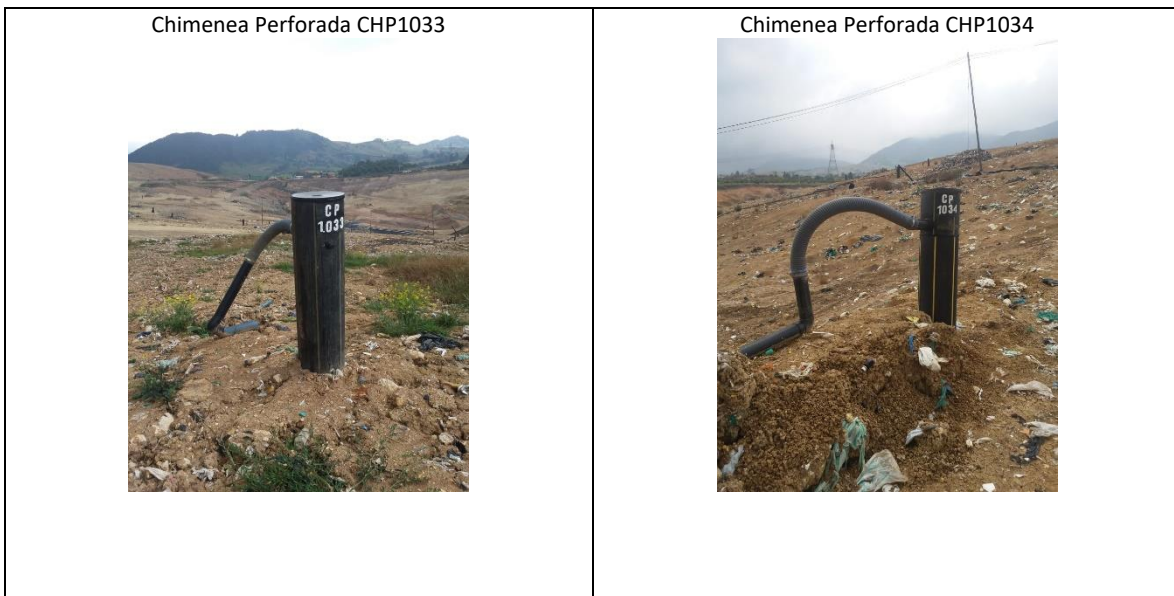
Foto 6 Chimeneas perforadas conectadas al sistema de extracción forzada por el Concesionario Biogás Doña Juana
