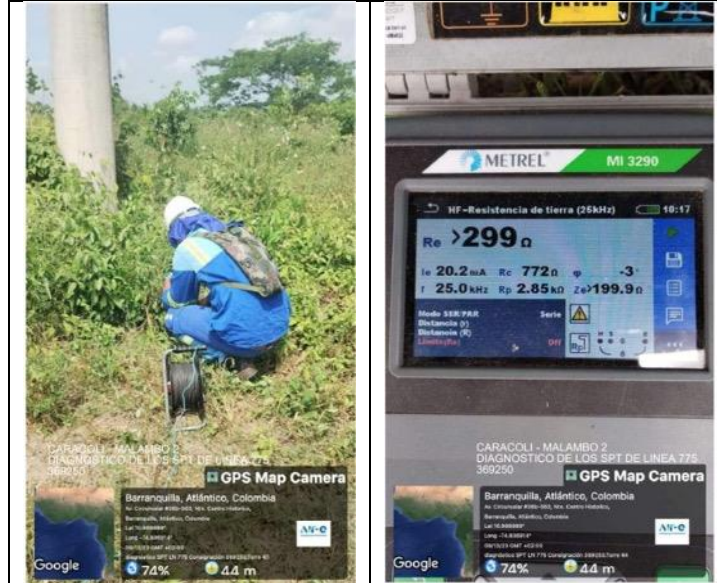
Fuente: AIR-E Informe Tercer Trimestre 2023
