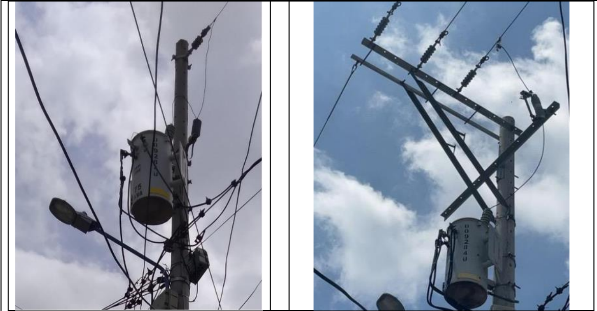
Fuente: AIR-E Informe Tercer Trimestre 2023
