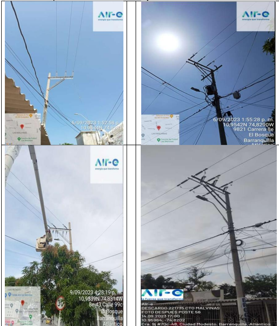
Fuente: AIR-E Informe Tercer Trimestre 2023
