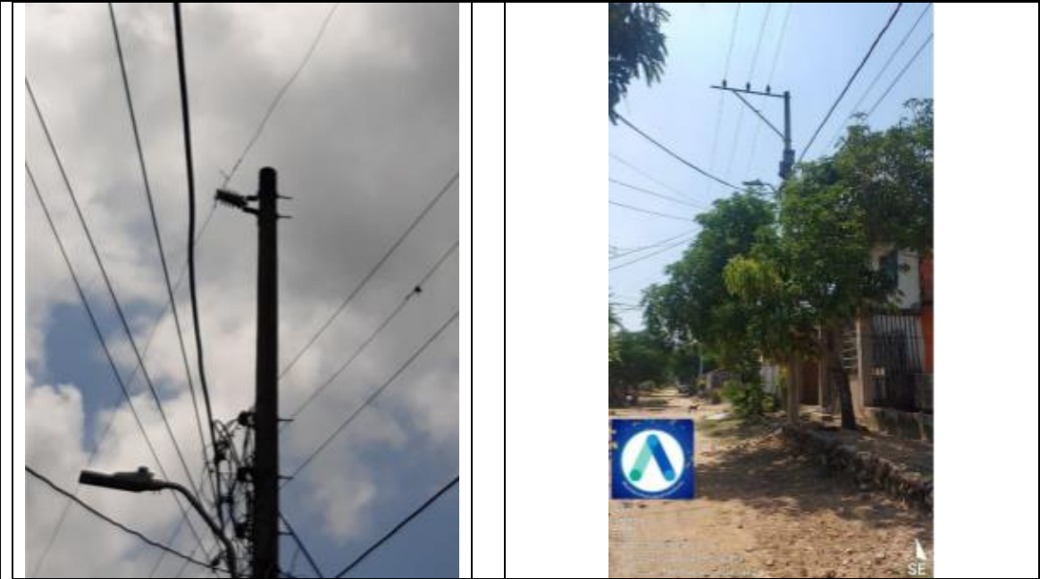
Fuente: AIR-E Informe Tercer Trimestre 2023
