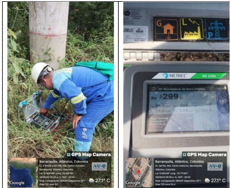
Fuente: AIR-E Informe Tercer Trimestre 2023
