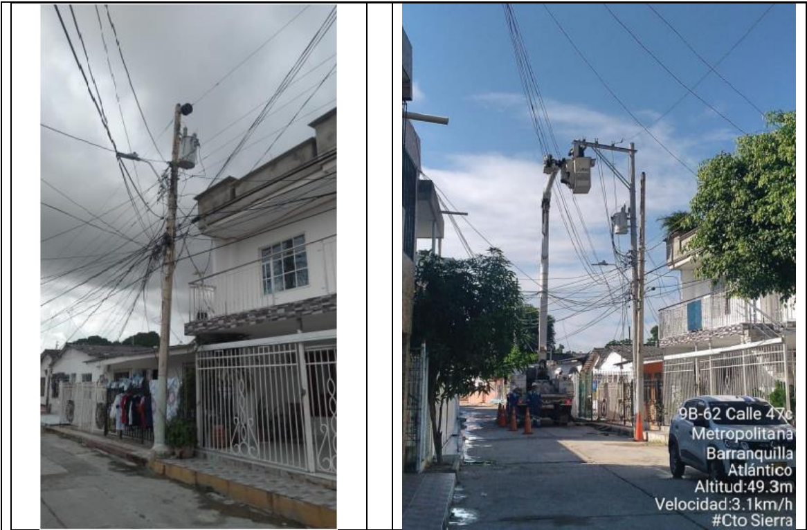
Fuente: AIR-E Informe Tercer Trimestre 2023
