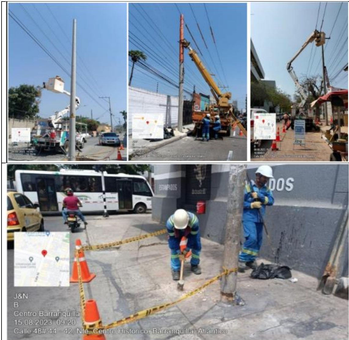
Fuente: AIR-E Informe Tercer Trimestre 2023
