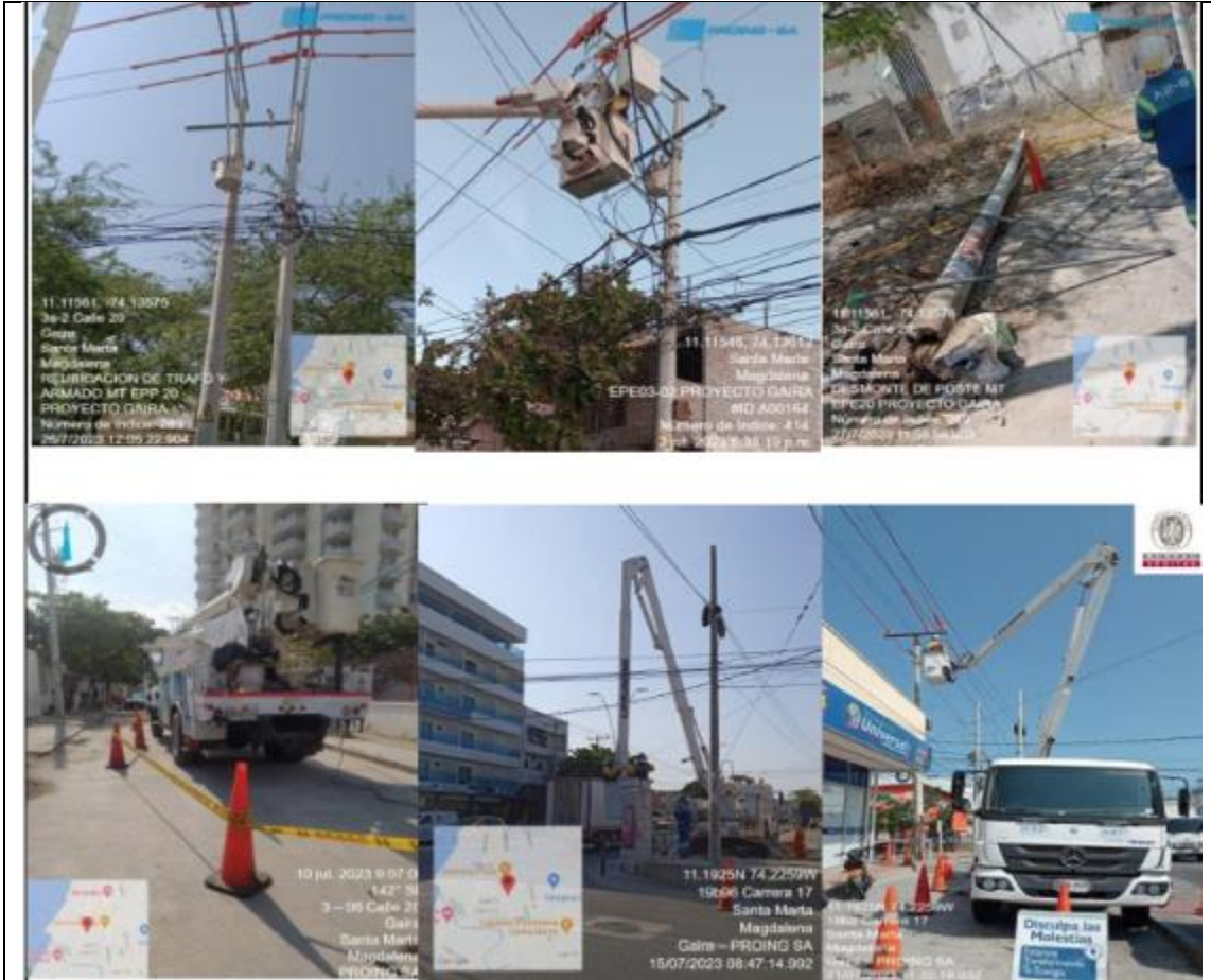
Fuente: AIR-E Informe Tercer Trimestre 2023
