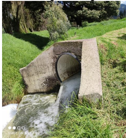
Imagen 12. Descarga de las aguas residuales
