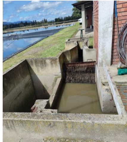
Imagen 7. Rejillas de cribado
