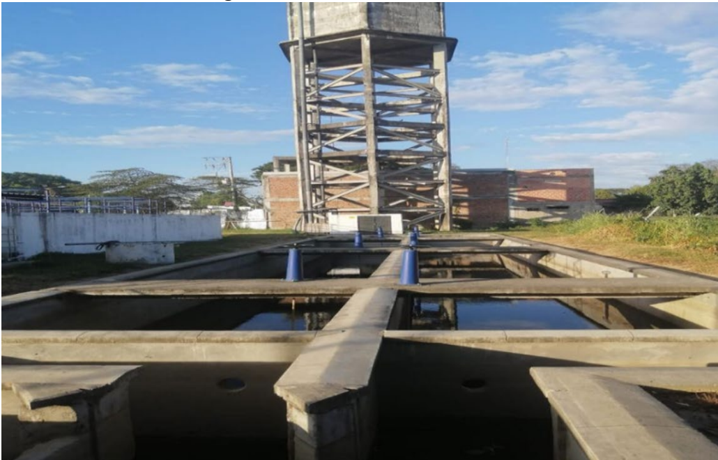
Imagen 5 Desarenadores PTAP Saldaña
