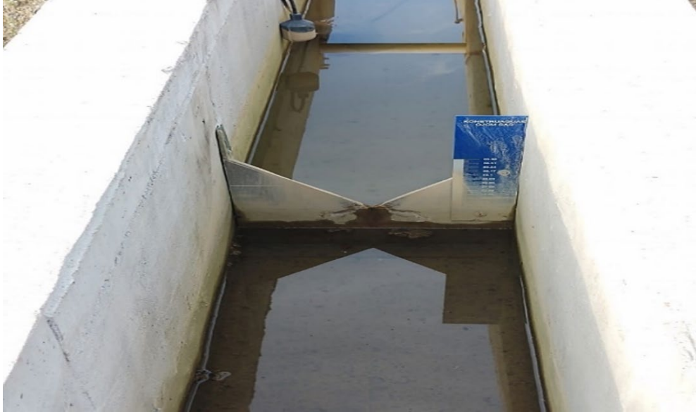
Imagen 6 Floculador PTAL Saldaña
