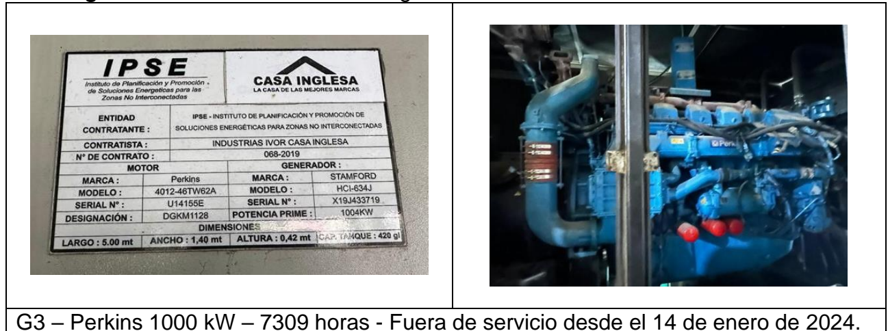
Figura 15. Unidad 3 – Central de generación Acandí – EMSELCA S.A. E.S.P.
