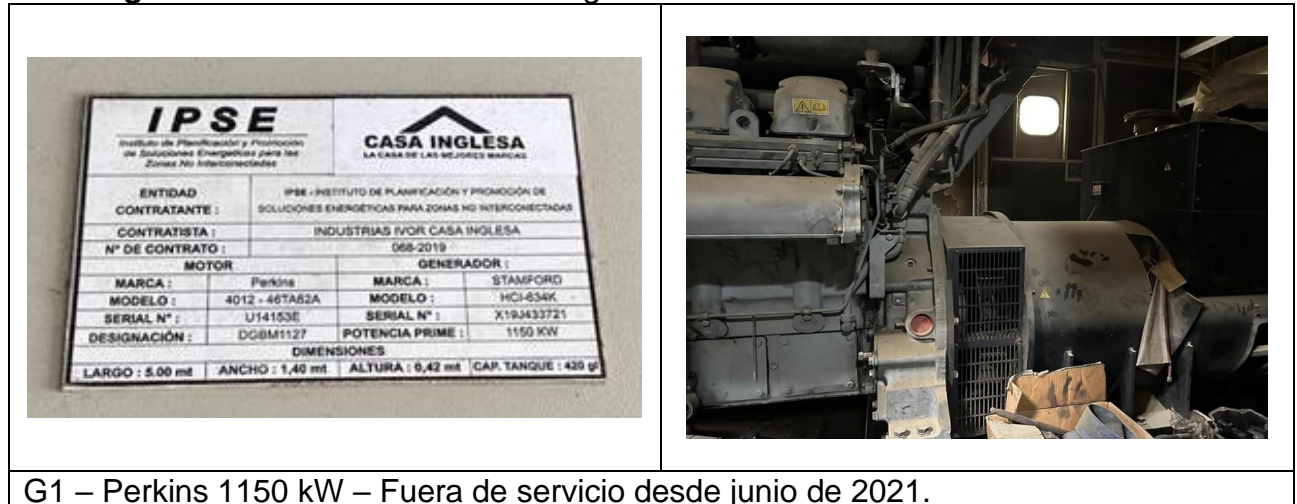
Figura 13. Unidad 1 – Central de generación Acandí – EMSELCA S.A. E.S.P.
