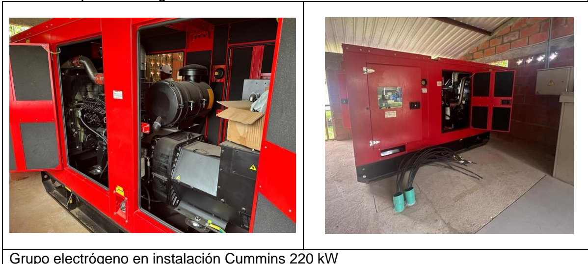
Figura 33. Grupos electrógeno nuevo en instalación en la localidad San Francisco – Triganá
