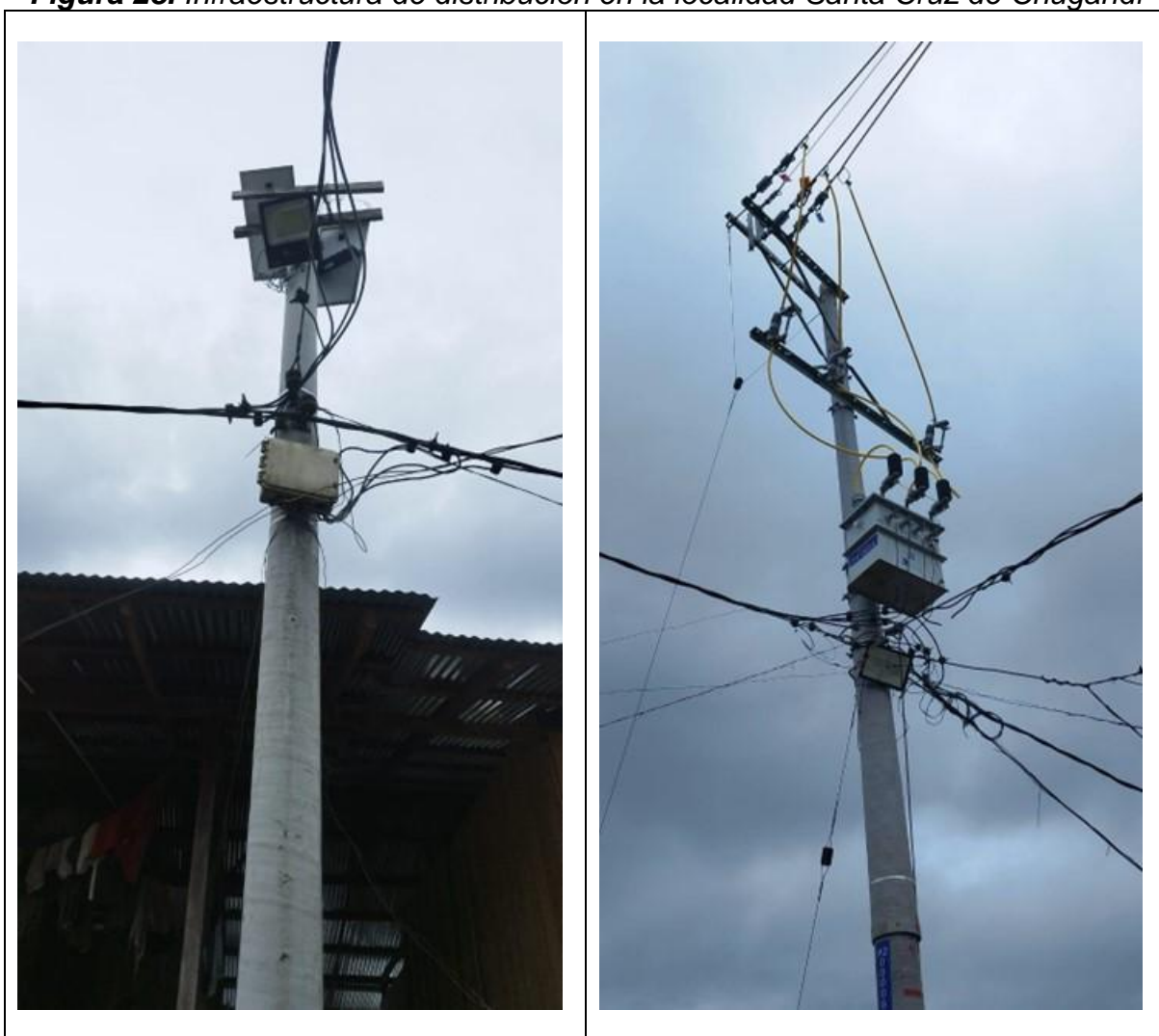
Figura 28. Infraestructura de distribución en la localidad Santa Cruz de Chugandí
