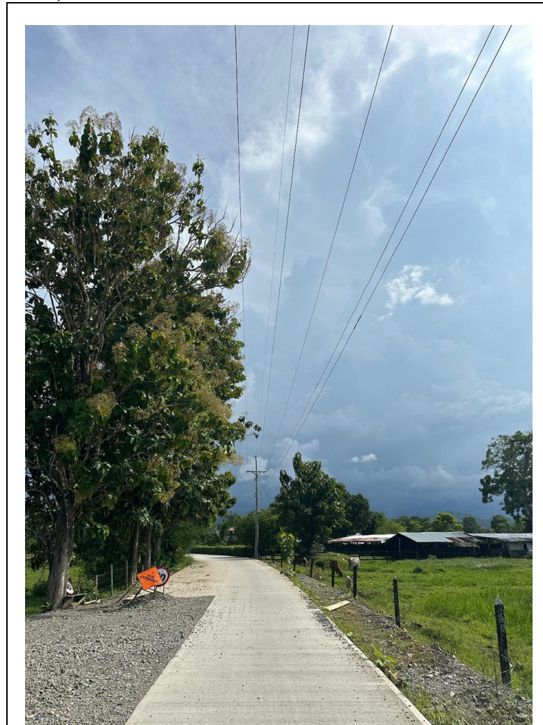
Derivación de la línea principal Acandí – San Miguel – Peñaloza hacia la comunidad de Caleta.
