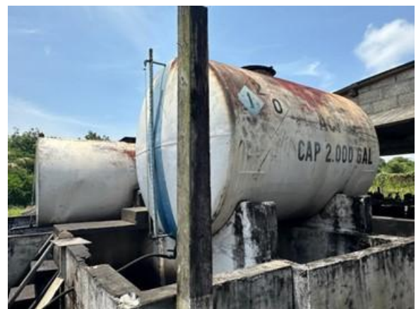
Tanque metálicos de 2.000 galones
