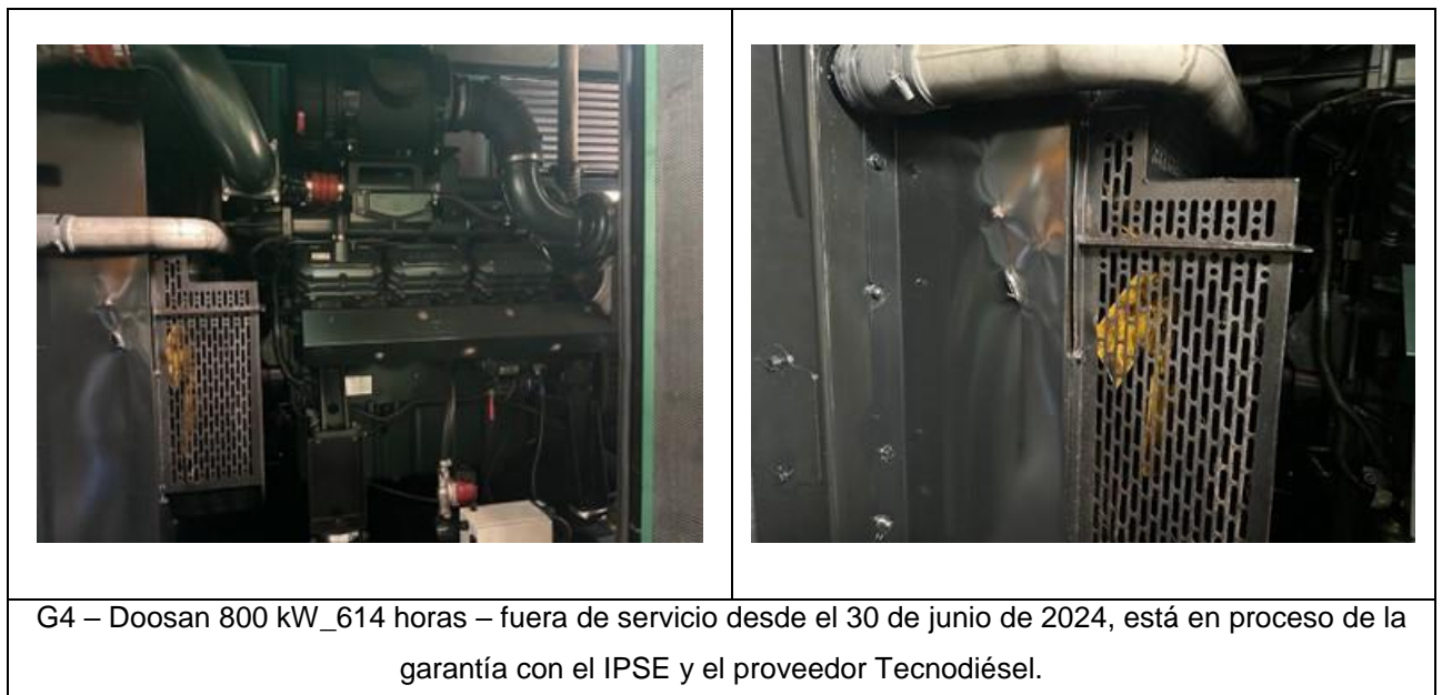
Figura 18. Unidad 4 – Central de generación Capurganá – JASEPCA ESP.
