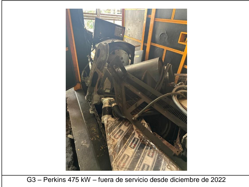
Figura 17. Unidad 3 – Central de generación Capurganá – JASEPCA ESP.
