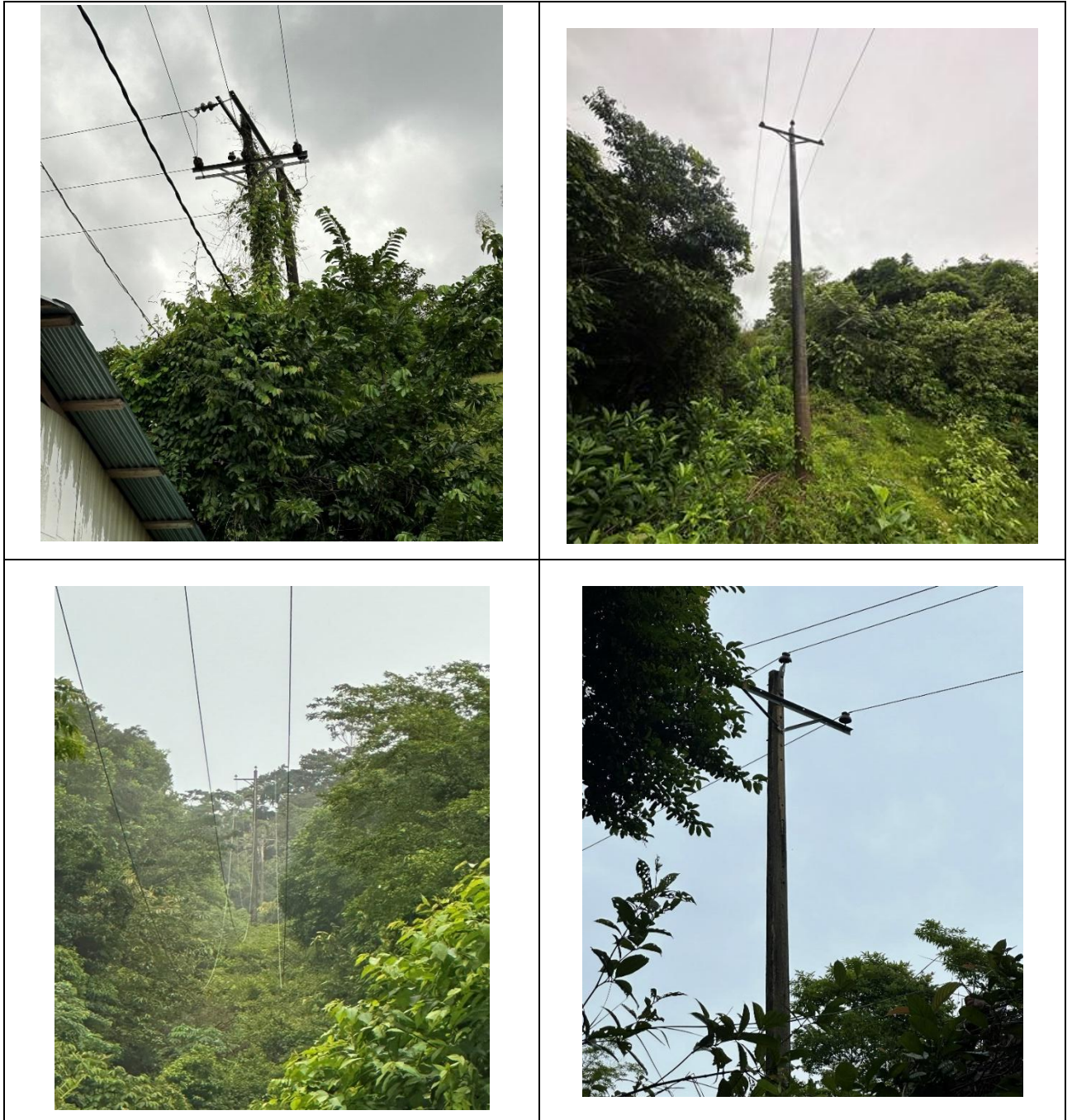
Figura 24. Recorrido Circuito en 13.2 kV Interconexión Capurganá – Sapzurro JASEPCA ESP.
