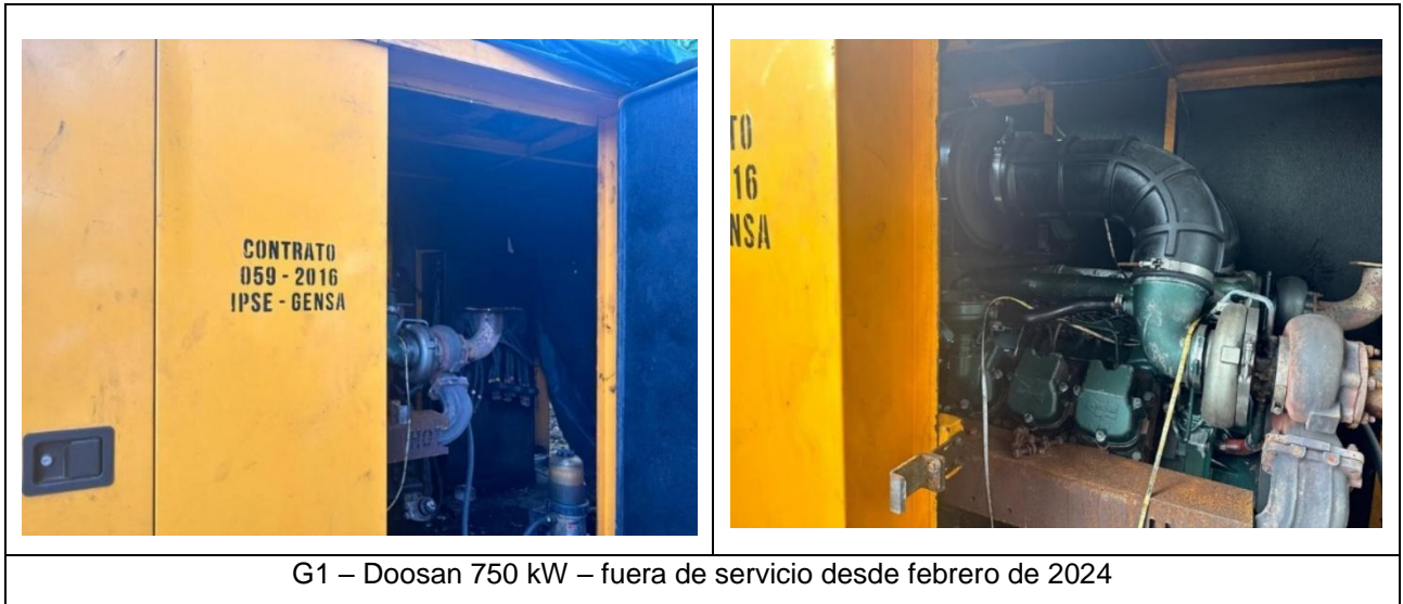
Figura 15. Unidad 1 – Central de generación Capurganá – JASEPCA ESP.
