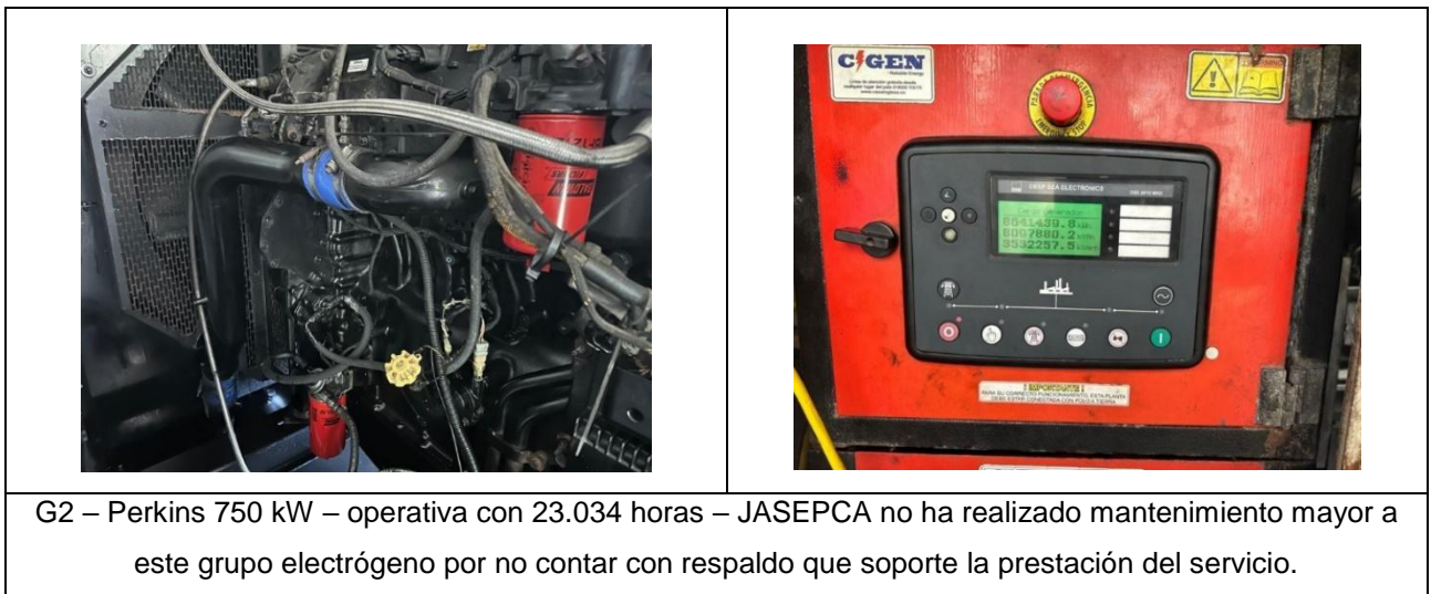
Figura 16. Unidad 2 – Central de generación Capurganá – JASEPCA ESP.
