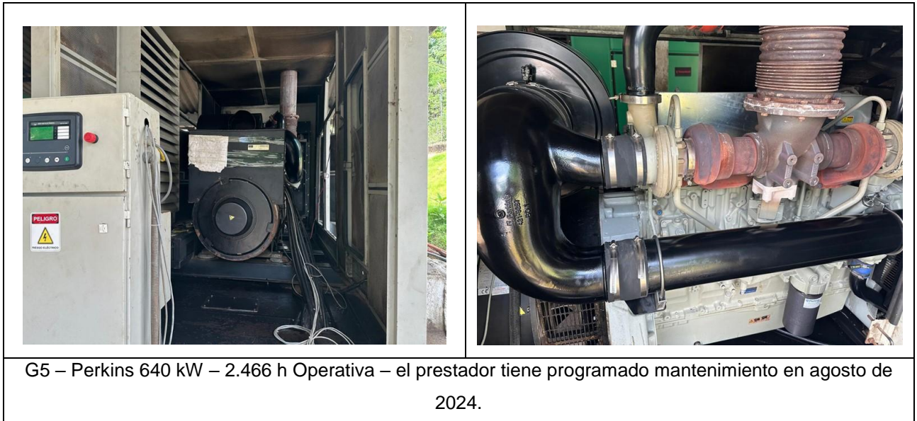
Figura 19. Unidad 5 – Central de generación Capurganá – JASEPCA ESP.
