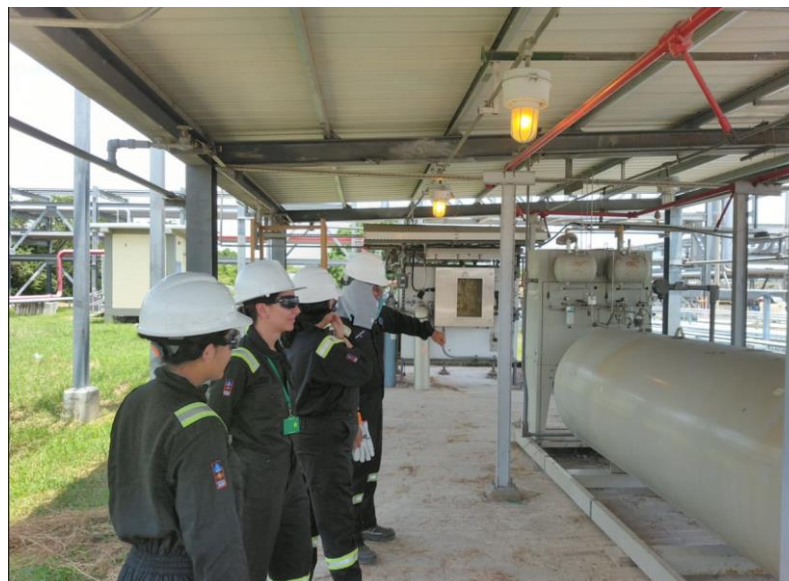
Figura 4 Sistema de Odorización en la Refinería de Cartagena
