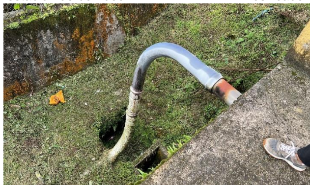
Tubería de salida para distribución
