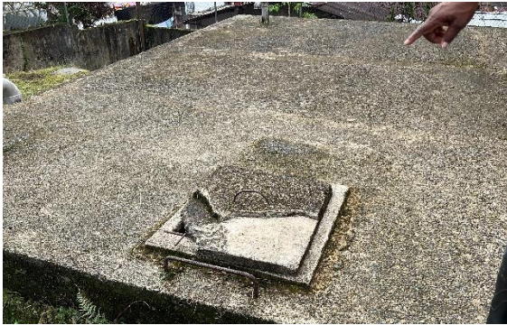
Tanque de almacenamiento y contacto de cloro
