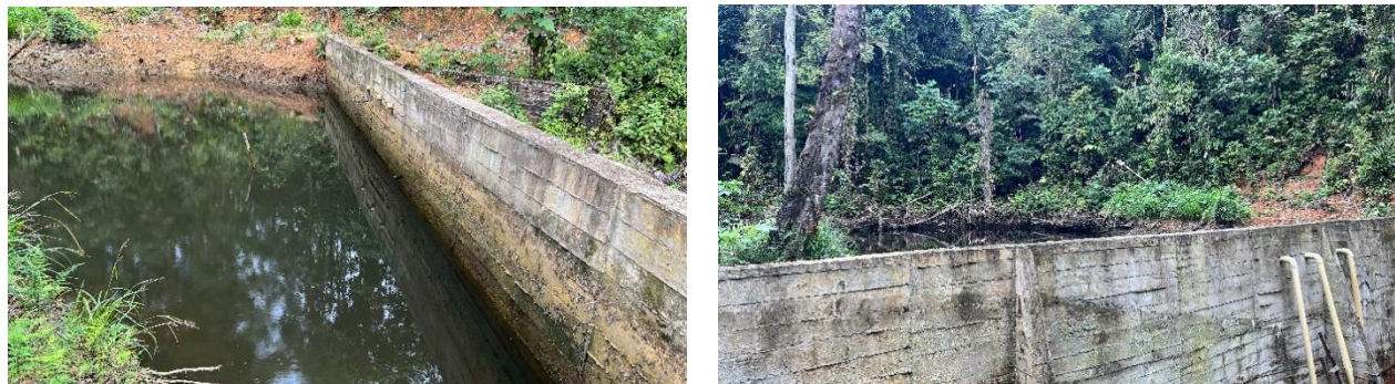
Captación Quebrada La Tatabrera
