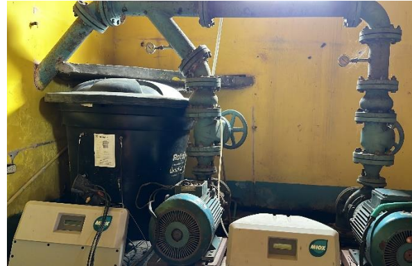
Estación de bombeo PTAP
