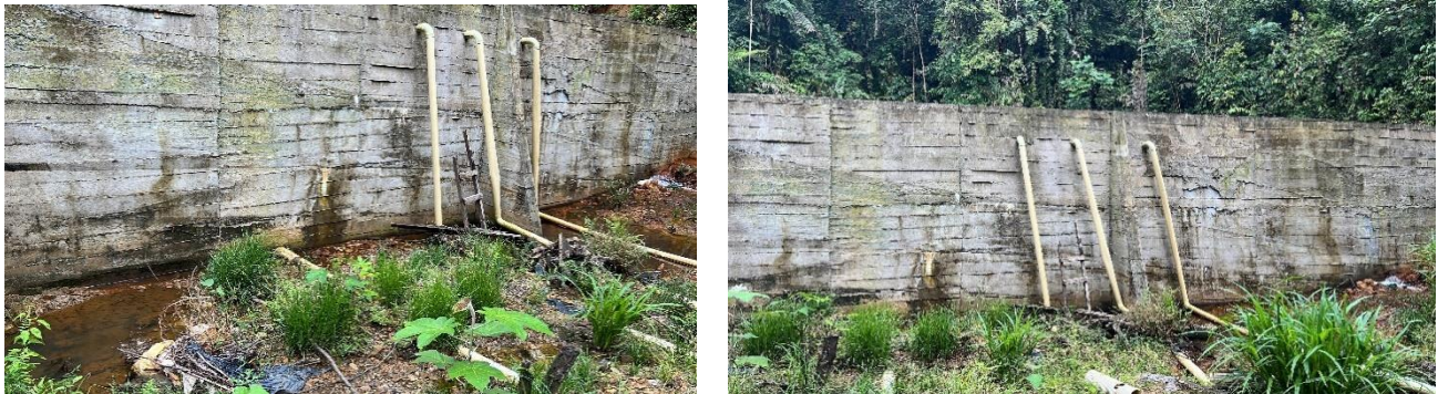
Estructura de ingreso captación Quebrada La Tatabrera Fuente: Registro fotográfico de la visita SSPD, noviembre de 2024.
