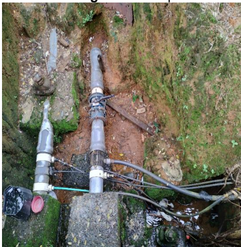
Salida del tanque de almacenamiento
