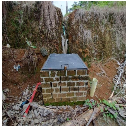
Tanque de adición de desinfectante
