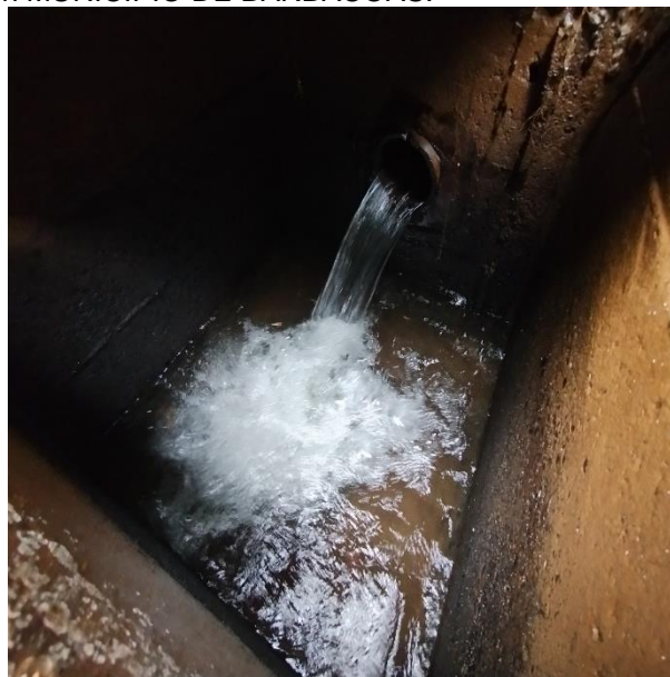
Tanque de conducción
