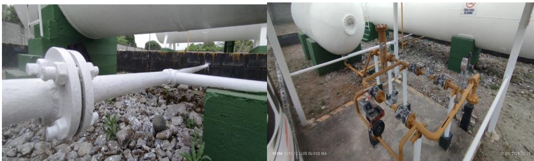
Imagen 8. Tuberías de gas GLP líquido y vapor
