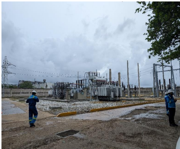
Vista panorámica de la subestación
