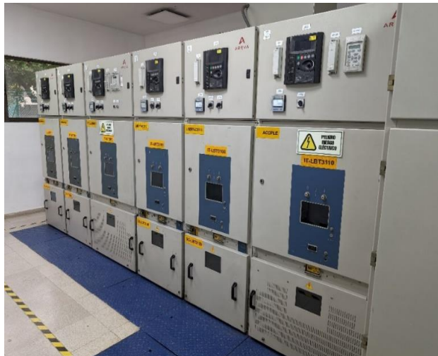
Celdas de protección y control 13,8 kV
