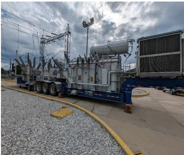
Subestación móvil que incluye transformador 110/34,5 kV y bahía de línea.
