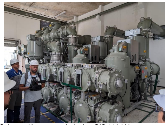
Subestación encapsulada tipo GIS 110 kV
