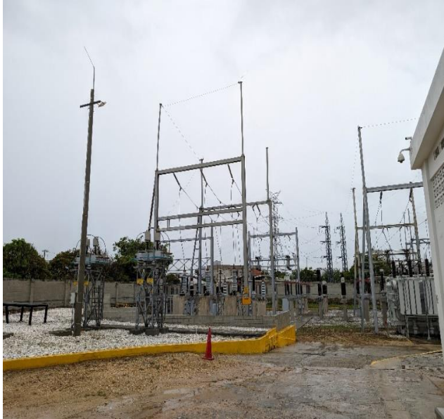
Panorámica de bahías de línea a 110 kV
