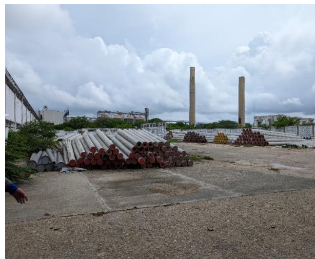
La subestación cuenta con un espacio adicional el cual será destinado para futuras expansiones y proyectos, pero que en el momento está siendo utilizado para depósito de postes. Estos postes hacen parte de las UC especiales aprobadas por la CREG.
