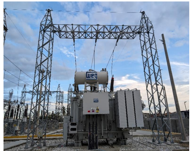
En la imagen se muestra uno de los dos transformadores de 50 MVA instalados en la subestación ejecutados como parte del plan de inversión. Al fondo se puede evidenciar las bahías de línea de estos, las cuales también fueron construidas como parte del plan.
