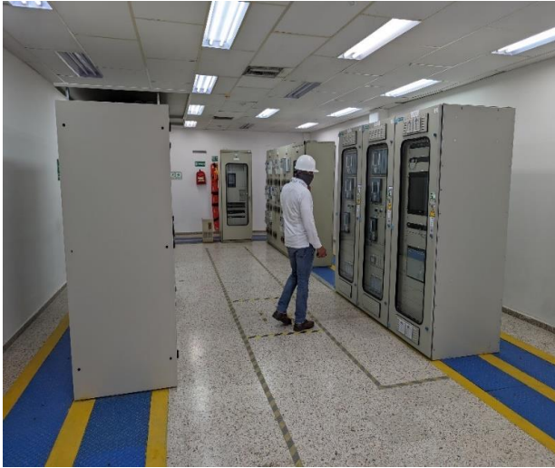
Celdas de control y protección e circuitos a 110 kV. Celdas de comunicación, medición y servicios auxiliares
