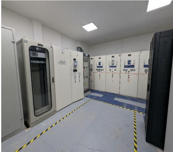
Celdas de protección y control a 34,5 kV y servicios auxiliares.
