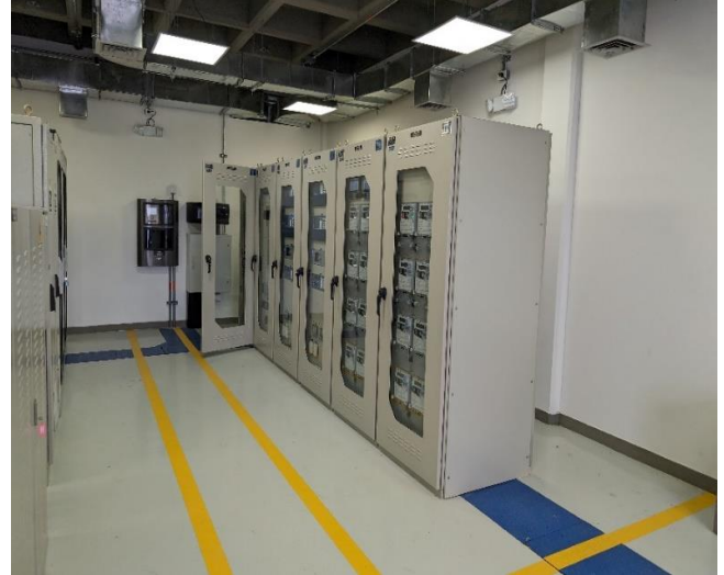
Celdas de medición y control.
