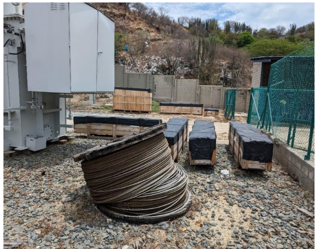
Material complementario para la ejecución del proyecto de inversión. La expectativa de puesta en operación del nuevo transformador es octubre de 2024.
