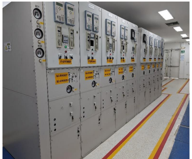
Celdas de protecciones y maniobras en 34,5 kV.
