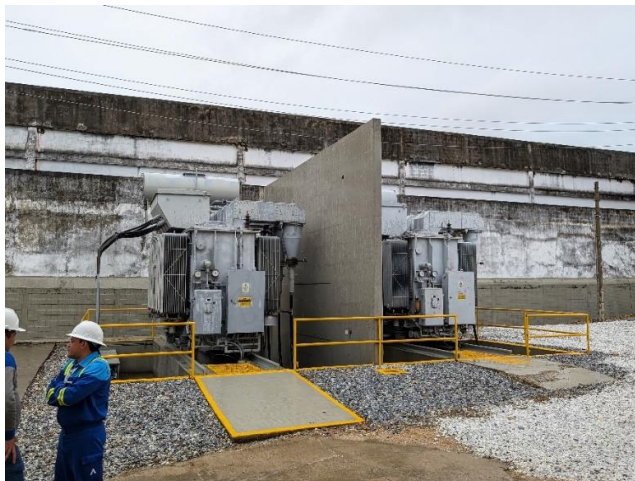
Transformadores de 110/34,5 kV de capacidades de 50 MVA
