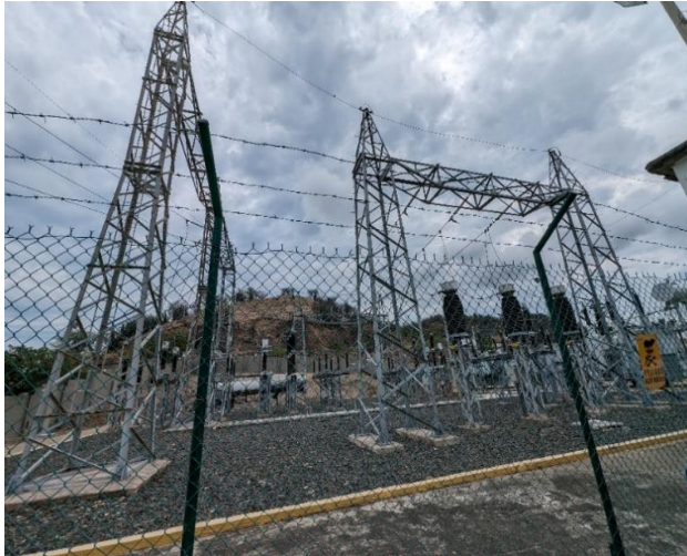
Bahía de línea 110 kV
