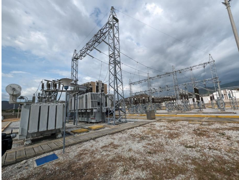
Vista panorámica de la subestación en la que se pueden observar las bahías de línea 110 kV de la subestación y transformador tridevanado.
