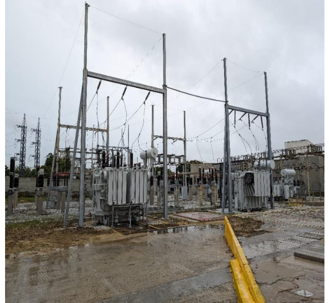
Dos transformadores de potencia 110/34,5 kV de capacidad 70 MVA cada uno.
