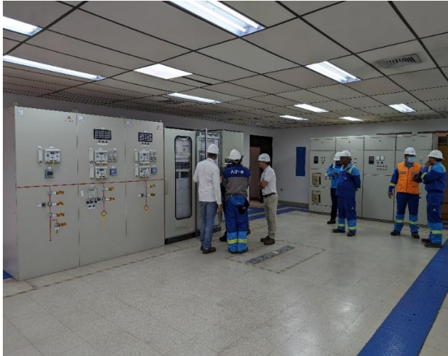
Celdas de protección y control 110 kV y celdas de comunicaciones y servicios auxiliares.
