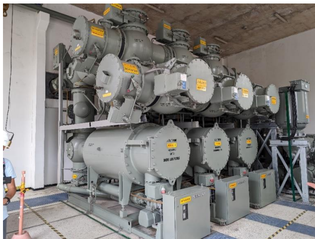
Subestación encapsulada tipo GIS 110 kV
