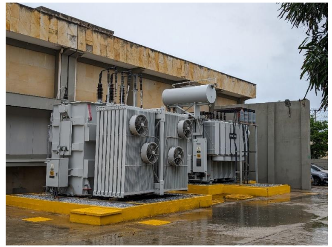
Transformadores 34,5/13,8 de capacidad 39,15 MVA y 28 MVA.
