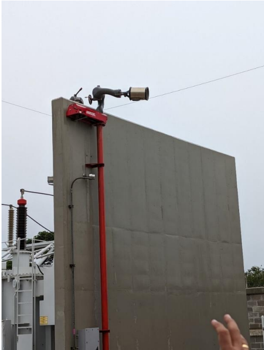
Sistema automático contra incendios en transformadores. En la foto se muestra una de dos mangueras a través de la cual se dispersa líquido especializado para apagar incendios en transformadores y se activa automáticamente cuando se detectan cambios repentinos de temperatura.
