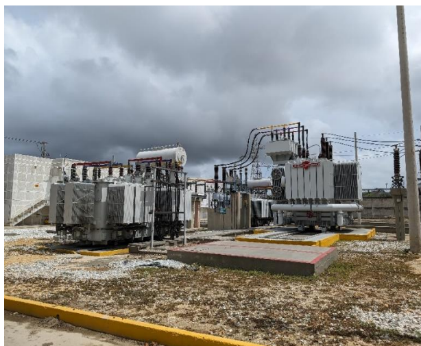
La subestación cuenta con tres transformadores 34,5/13,8 kV de capacidades 25, 25 y 21 MVA para una capacidad máxima de 71 MVA
