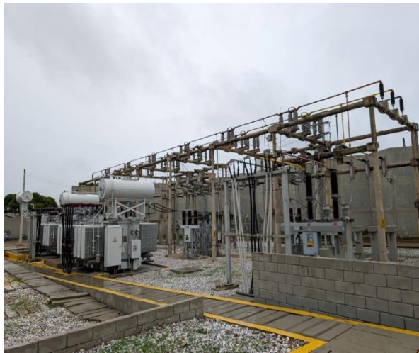
Bahías de línea 34,5 kV con estructura en concreto tipo americana. En la fotografía se observan tres transformadores de potencia 34,5/13,8 kV de capacidades de 30, 30 y 40 MVA.
