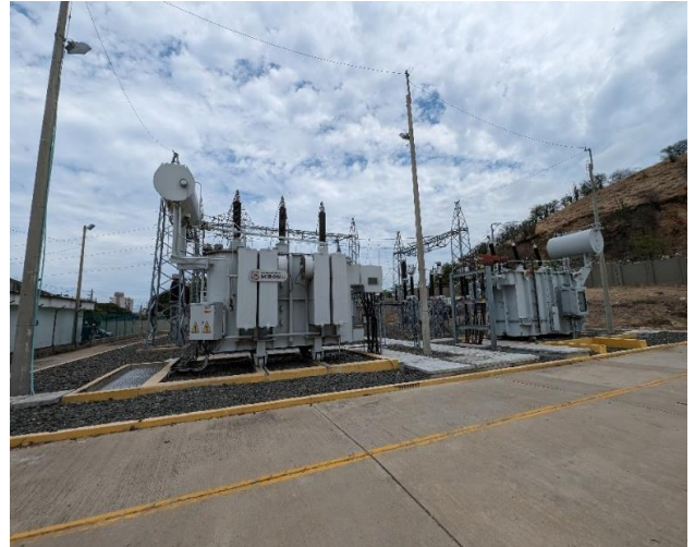
Dos transformadores de potencia de 30 MVA.
