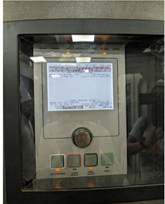
Sistema automático contra incendios en transformadores. En la foto se muestra el panel de detección automática de incendios.
