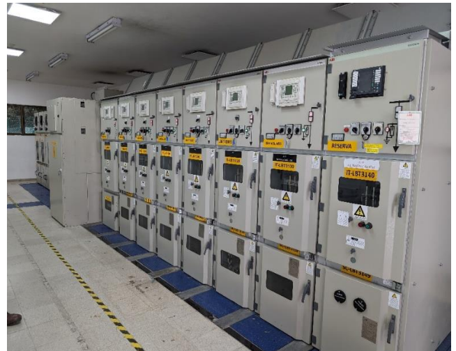
Celdas de protección y control 13,8 kV
