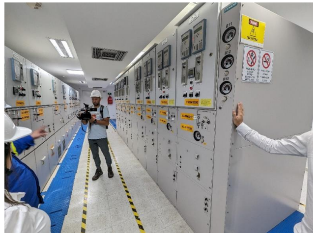
Celdas de protección y control de líneas a 34,5 kV..
