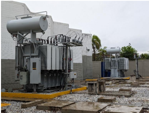
Transformadores 34,5/13,8 kV de capacidad 40 MVA cada uno.
