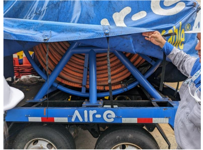
Cable tipo Jumper adquirido a través del plan de inversiones y que apoya actividades de mantenimiento y ejecución de inversiones.
