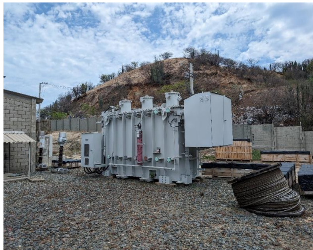
Como parte del plan de inversión, se ejecutará durante este año la repotenciación de uno de los transformadores de esta subestación de una capacidad de 30 a 50 MVA. El transformador a ser instalado se puede evidenciar en la fotografía,
