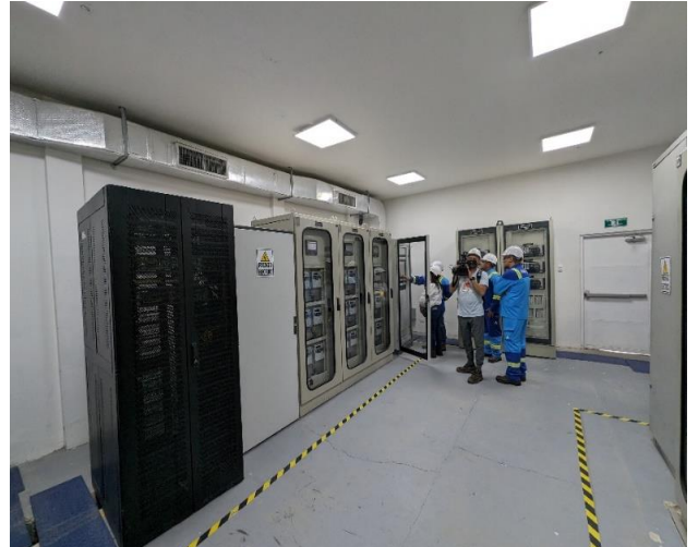
Celdas de medición y medición diferencial, y paneles de comunicaciones.
