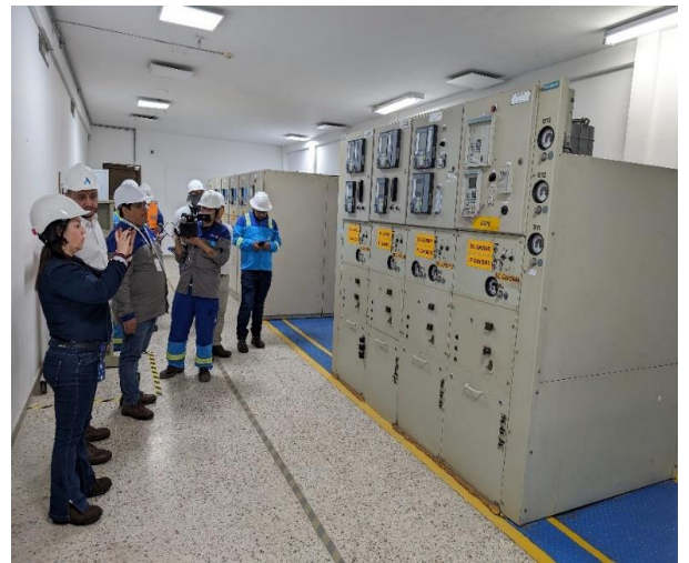
Celdas de control y protección de circuitos a 34,5 kV y 13,8 kV.
