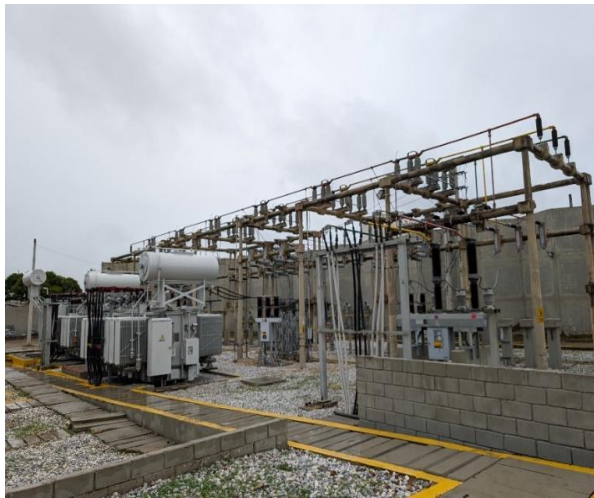
Bahías de línea 34,5 kV con estructura en concreto tipo americana. En la fotografía se observan tres transformadores de potencia 34,5/13,8 kV de capacidades de 30, 30 y 40 MVA.
