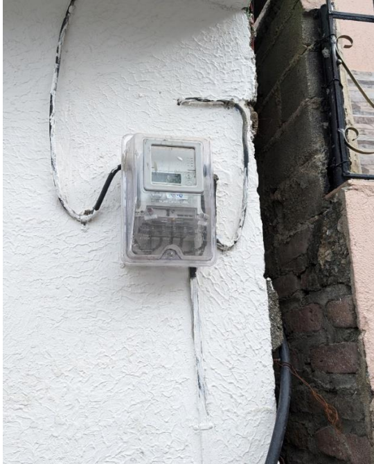
Medición inteligente instalada en facha de usuario.
