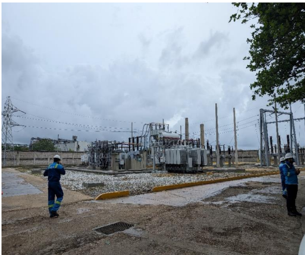
Vista panorámica de la subestación
