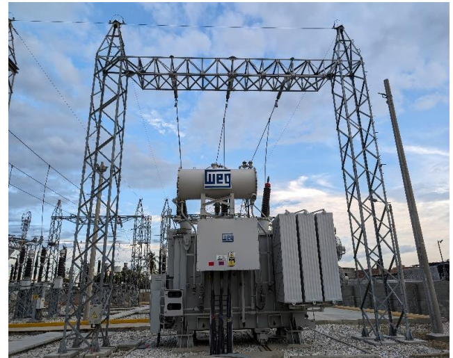
En la imagen se muestra uno de los dos transformadores de 50 MVA instalados en la subestación ejecutados como parte del plan de inversión. Al fondo se puede evidenciar las bahías de línea de estos, las cuales también fueron construidas como parte del plan.
