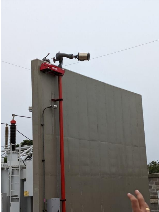
Sistema automático contra incendios en transformadores. En la foto se muestra una de dos mangueras a través de la cual se dispersa líquido especializado para apagar incendios en transformadores y se activa automáticamente cuando se detectan cambios repentinos de temperatura.
