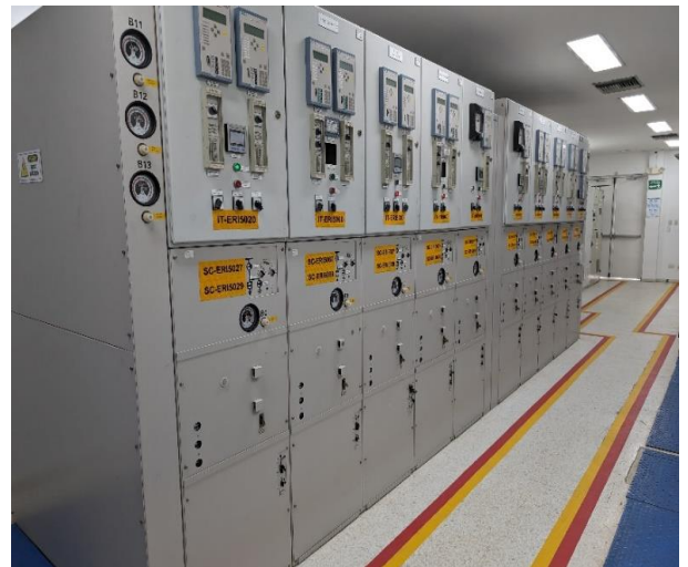
Celdas de protecciones y maniobras en 34,5 kV.
