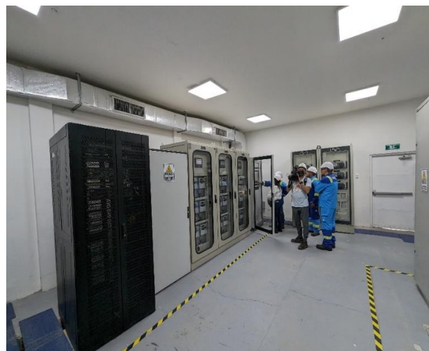
Celdas de medición y medición diferencial, y paneles de comunicaciones.
