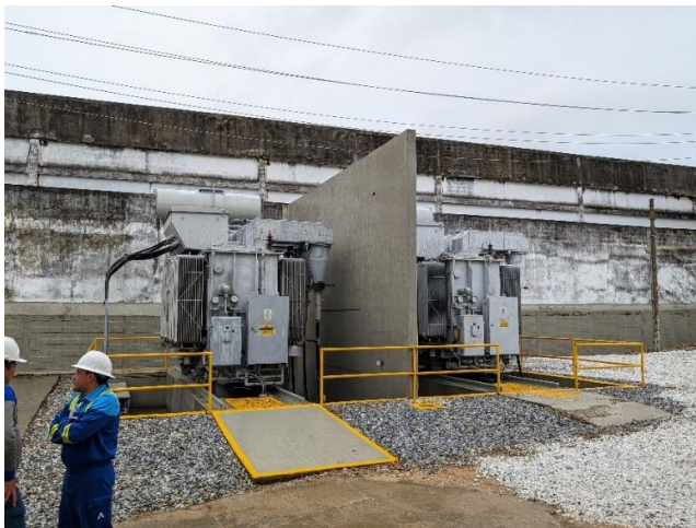
Transformadores de 110/34,5 kV de capacidades de 50 MVA
