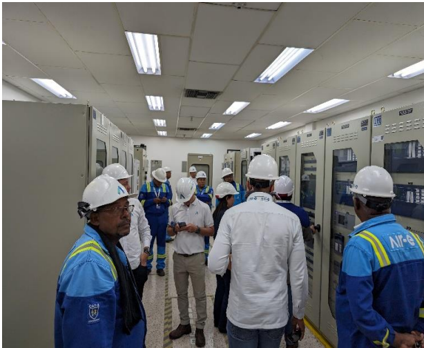
Celdas de control y protección y circuitos a 110 kV. Celdas de comunicación, medición y servicios auxiliares.
