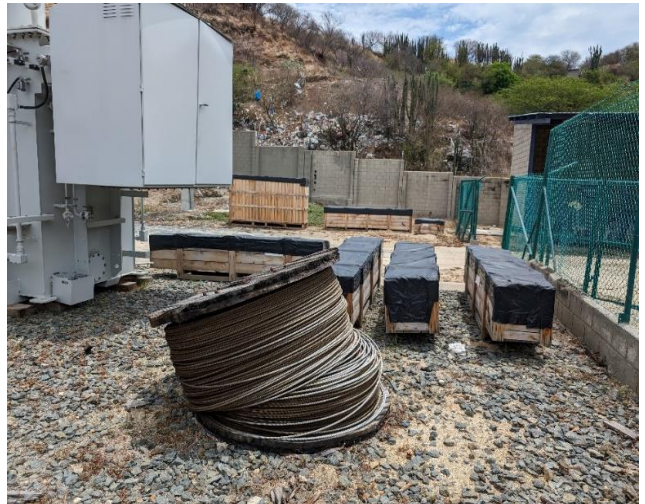
Material complementario para la ejecución del proyecto de inversión. La expectativa de puesta en operación del nuevo transformador es octubre de 2024.
