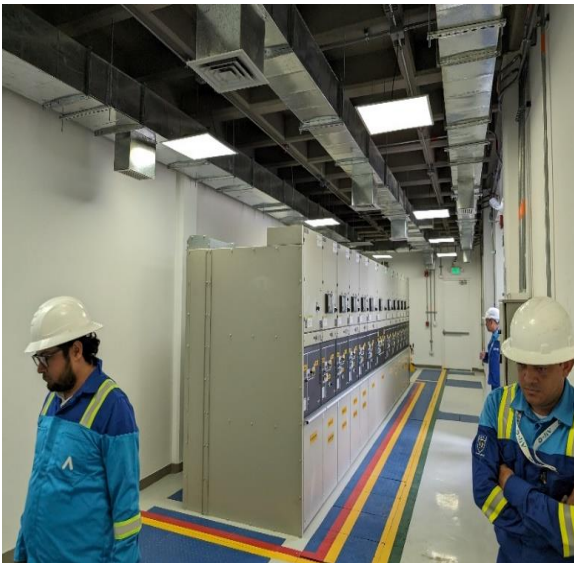
Celdas de protección y control a 13,8 kV.
