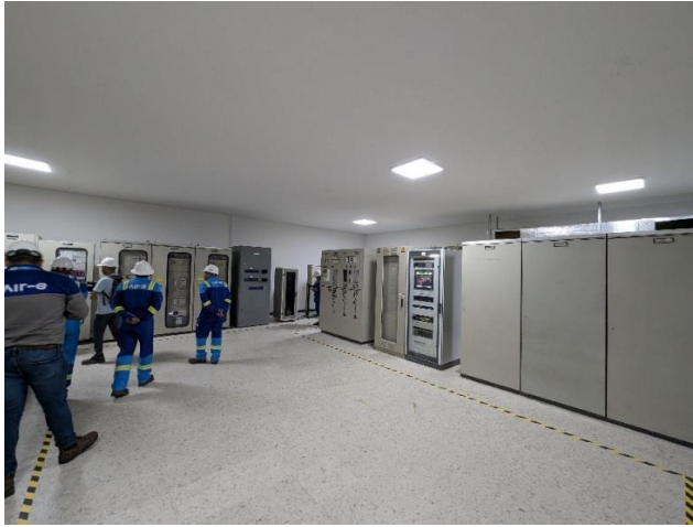
Celdas de protección, control y comunicación.
