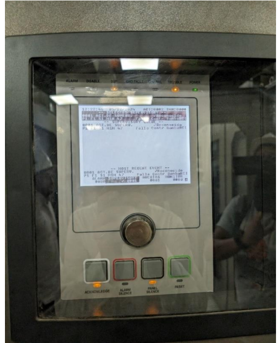
Sistema automático contra incendios en transformadores. En la foto se muestra el panel de detección automática de incendios.
