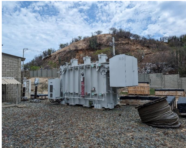
Como parte del plan de inversión, se ejecutará durante este año la repotenciación de uno de los transformadores de esta subestación de una capacidad de 30 a 50 MVA. El transformador a ser instalado se puede evidenciar en la fotografía,
