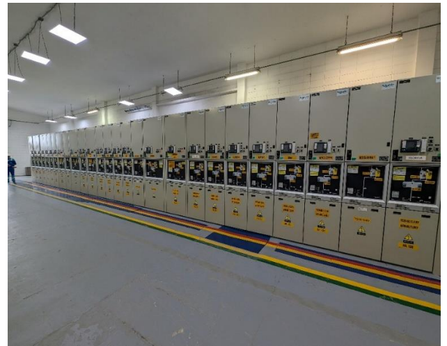
Celdas de protección y control 13,8 kV
