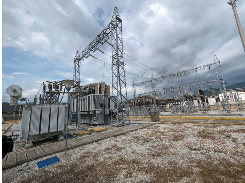
Vista panorámica de la subestación en la que se pueden observar las bahías de línea 110 kV de la subestación y transformador tridevanado.
