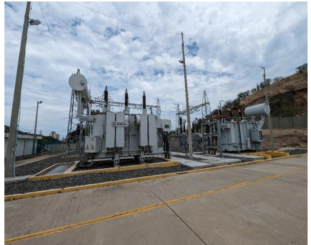
Dos transformadores de potencia de 30 MVA.
