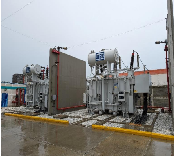
Dos transformadores de potencia de capacidad de 30 MVA cada uno.
