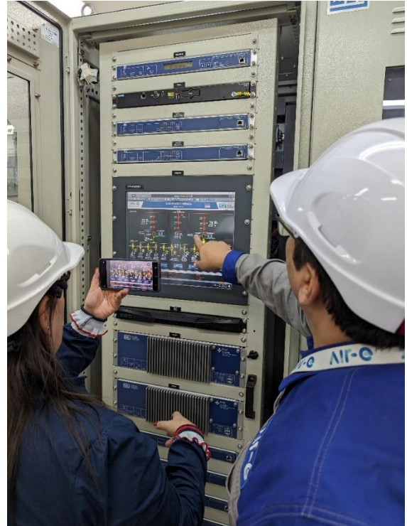
Interfaz humano máquina (IHM) y verificación de niveles de cargabilidad de activos. Todas las subestaciones visitadas cuentan con este sistema.
