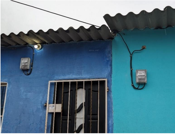
Displays instalados en las fachadas de los usuarios en los que se puede visualizar el consumo de facturado. Estos displays muestran la información registrada en los medidores ubicados a la altura de los postes.
