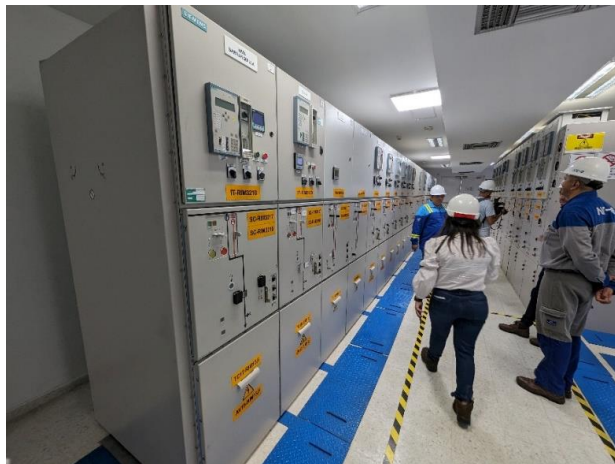
Celdas de protección y control de líneas a 13,8 kV.
