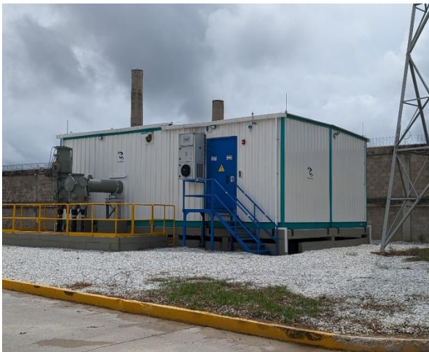
Centro de transformación tipo GIS. Esta fue ejecutado por terceros como parte de convocatoria por parte de la UPME
