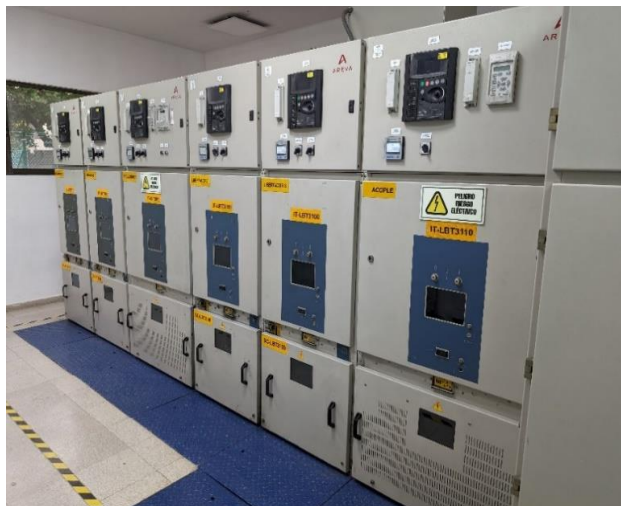
Celdas de protección y control 13,8 kV
