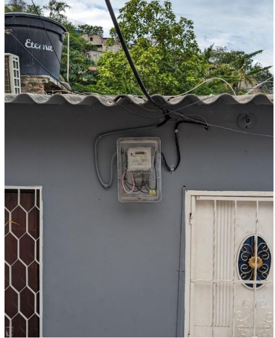
Medición inteligente instalada en facha de usuario.
