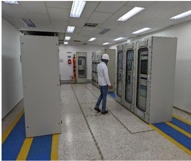
Celdas de control y protección e circuitos a 110 kV. Celdas de comunicación, medición y servicios auxiliares
