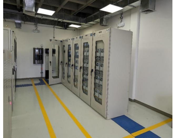
Celdas de medición y control.
