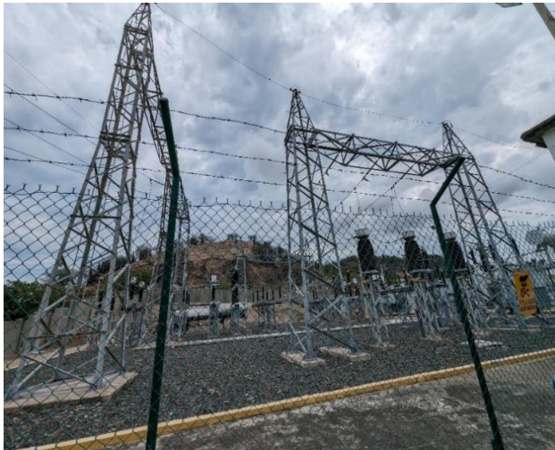
Bahía de línea 110 kV
