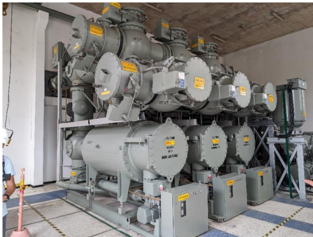
Subestación encapsulada tipo GIS 110 kV
