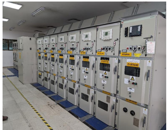
Celdas de protección y control 13,8 kV
