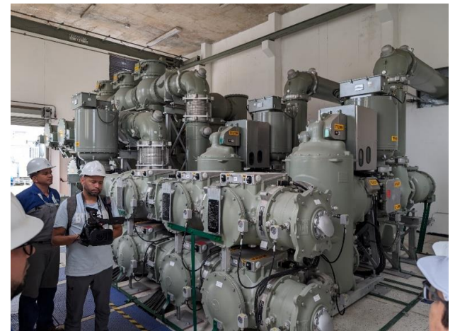
Subestación encapsulada tipo GIS 110 kV
