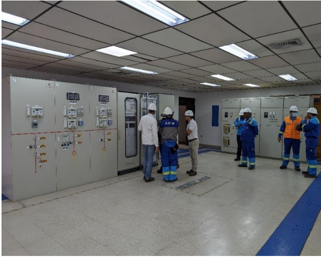
Celdas de protección y control 110 kV y celdas de comunicaciones y servicios auxiliares.
