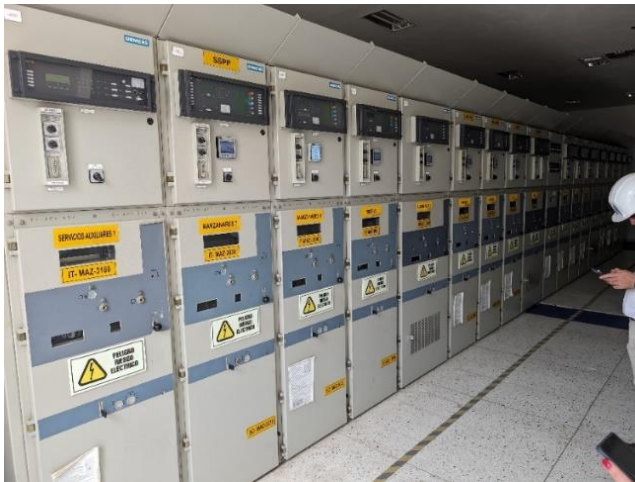
Celdas de protección y control 13,8 kV
