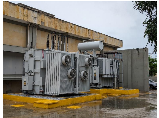
Transformadores 34,5/13,8 de capacidad 39,15 MVA y 28 MVA.
