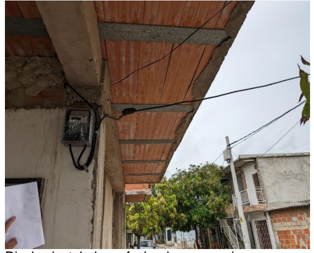
Display instalado en facha de un usuario y acometida.
