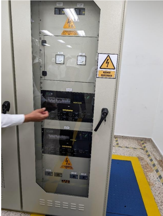
Cabina con rectificadores de baterías. La empresa destaca que si bien por diseño solo requería un sistema de rectificación, por redundancia y posibles decidieron implementar dos.
