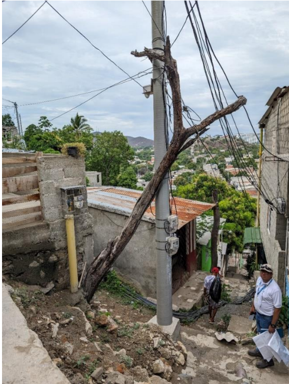
Situación de riesgo que deberá ser atendida por la empresa o autoridades locales.
