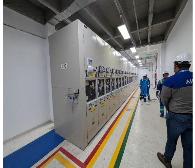
Celdas de protecciones y maniobras en 13,8 kV. Este arreglo de celdas se encuentra ubicado en ampliación realizada a la caseta de control de la subestación como parte del plan de inversión con el fin de mejorar las distancias de seguridad en la subestación.
