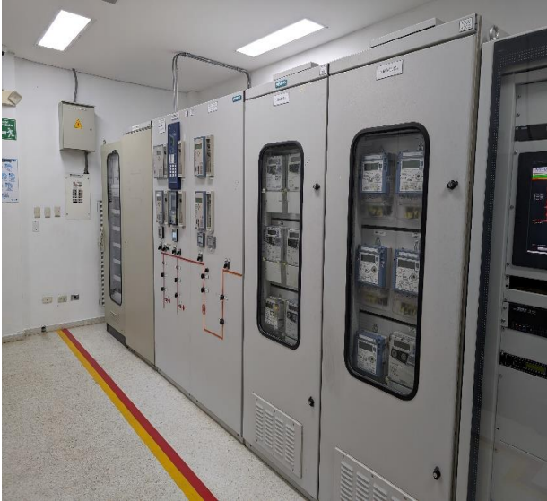
Celdas de comunicación y medición
