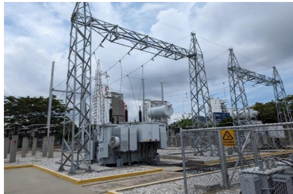
Bahía de línea 110, 34,5 kV y dos transformadores de 30 MVA. En la foto también se puede apreciar la torre de transmisión de que soporta el circuito de 110 kV de entrada a la subestación
