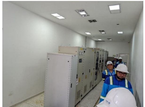
Celdas de protección y control 110 kV y celdas de comunicaciones, medición y servicios auxiliares.
