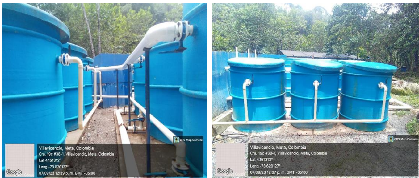
Imagen 20 Sistema de filtración
