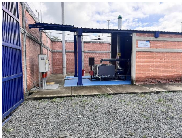
Imagen 2 Calderín Estación Matapalo
