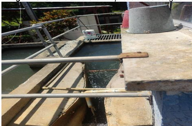
Imagen 18. Canaleta Parshall - aplicación de coagulante
