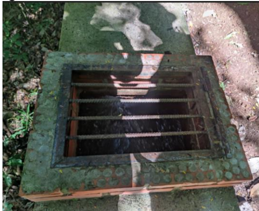
Imagen 14. Cámaras - Línea o canal de Aducción
