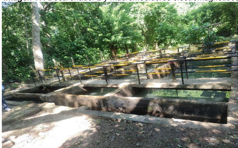
Imagen 17. Desarenador 2 y macromedidores electromagnéticos
