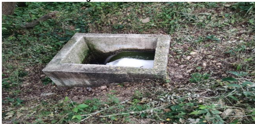
Imagen 58. Estructura de salida
