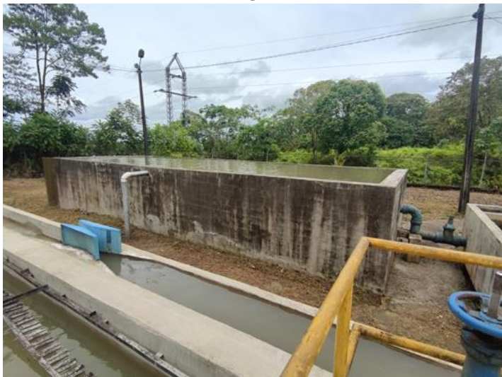
Imagen 9. Estructura de pretratamiento Empresa Eficiente de Servicios Públicos de Yuto S.A.S. E.S.P.
