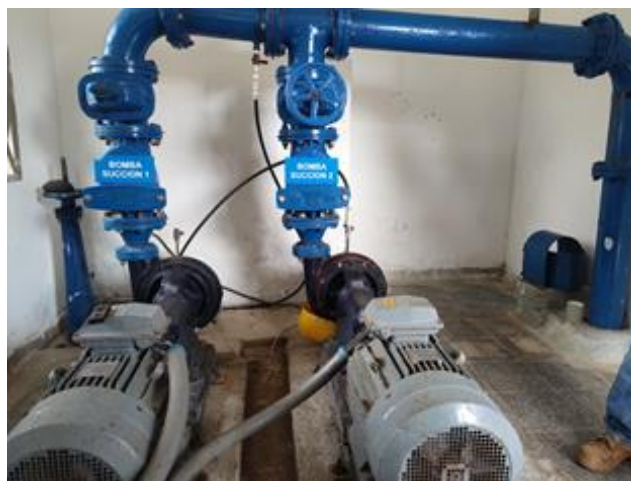
Equipos de Bombeo (2)
