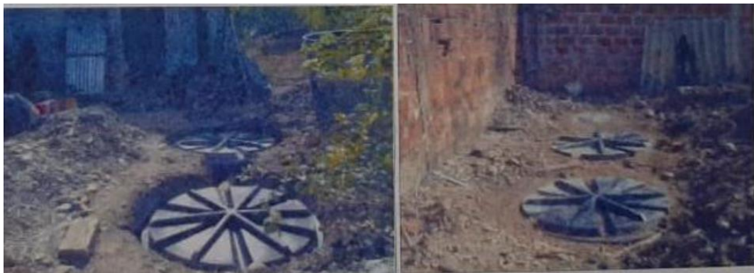
Sistema séptico construido Fuente: Empresa Eficiente de Servicios Públicos de Yuto S.A.S. E.S.P.
