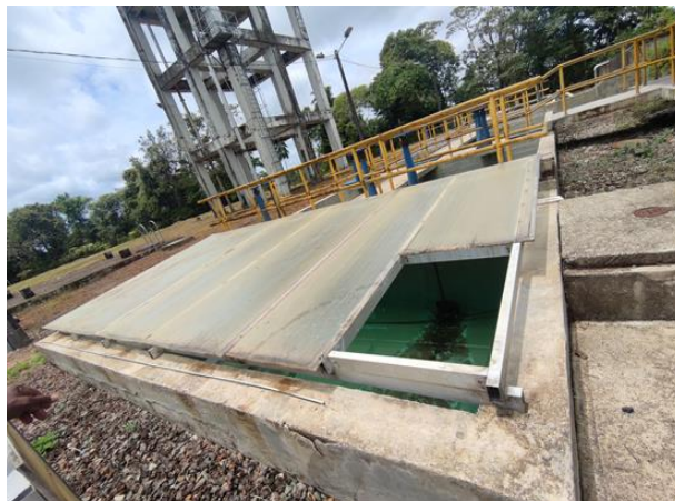
Tanque Aguas Filtradas ó de contacto
