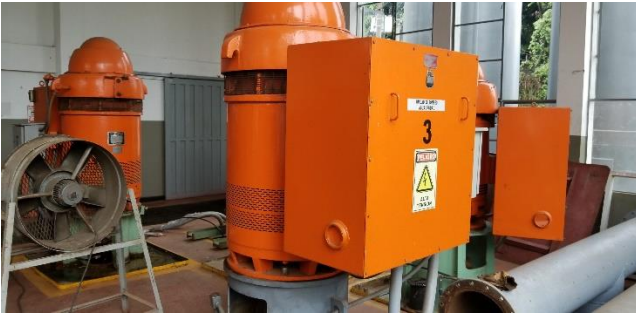
e) Unidades de bombeo.
