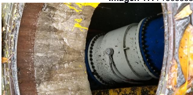
a) Macromedidor – Entrada a la planta.
