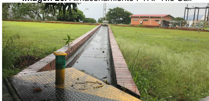
Tanque de Almacenamiento
