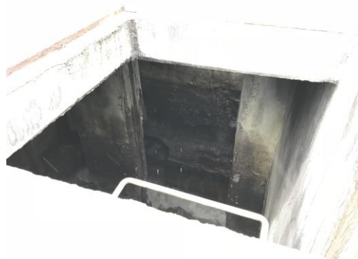
Salida de la PTAR
