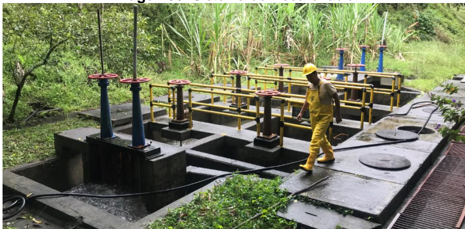
Sistema de Desarenadores.
