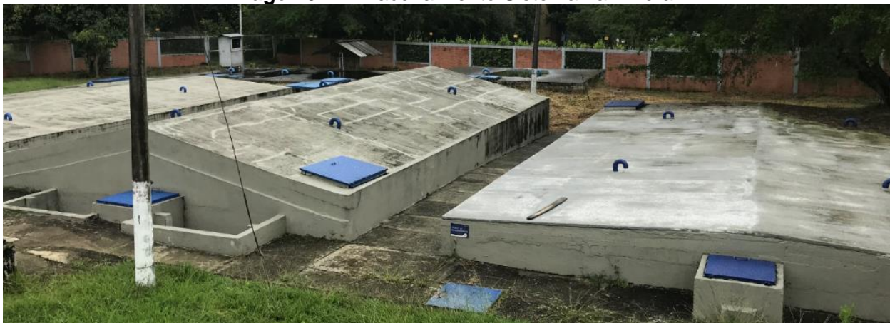
Tanques de almacenamiento
