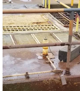
b) Macromedidor a la entrada de la PTAP.
