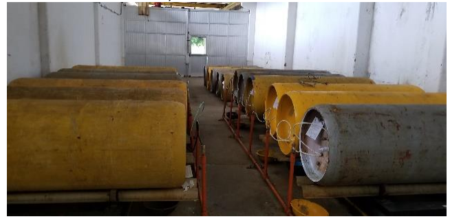
f) Tanques de cloro gaseoso.
