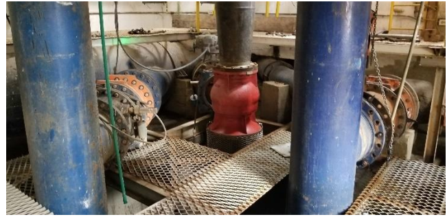
f) Sistema de bombeo.
