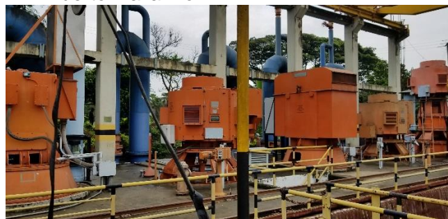
b) Unidades de bombeo.
