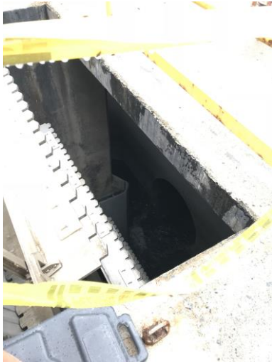
Tubería de llegada
