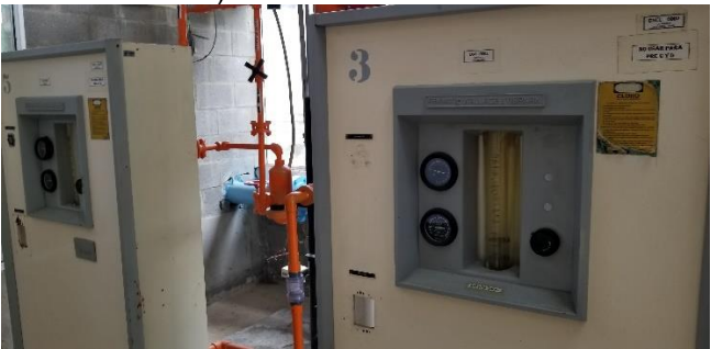
g) Dosificación de cloro gaseoso.
