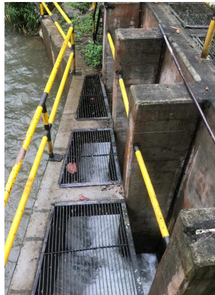
Rejillas de Captación
