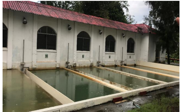
Sistema de Filtración
