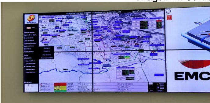
a) Imagen del sistema de acueducto.
