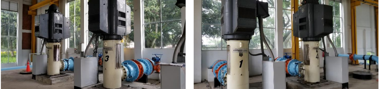
Imagen 18. Estación de bombeo de agua potable PTAP Río Cauca.
